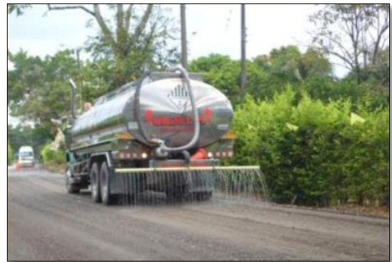
agua por toda la superficie. figura 6. Humedecimiento de la superficie. Fuente: PORTILLA, HERRERA, GONSALESZ, PEREZ Y VALDEZ (2013)
