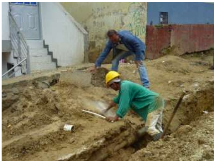
Figura 92. Daños en tubería, acueducto Tejarito.
