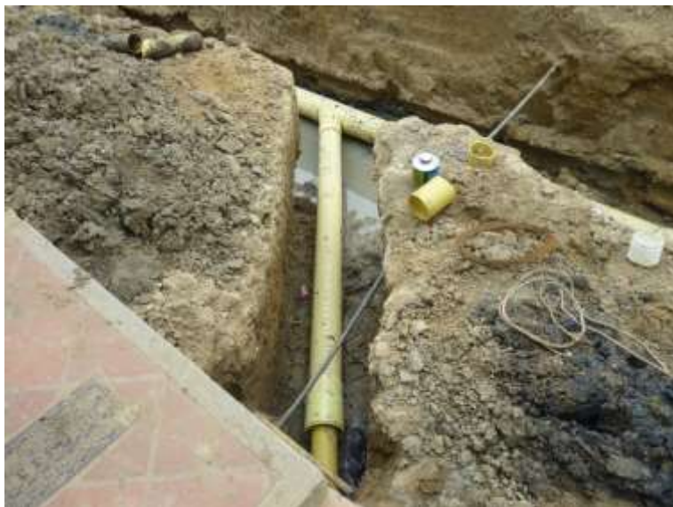
Figura 103. Acometidas, alcantarillado Tejarito.
