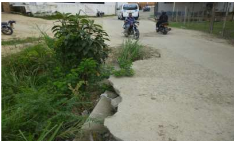
Figura 123. Estado actual del sector solicitante, proyecto muro en gavión.
