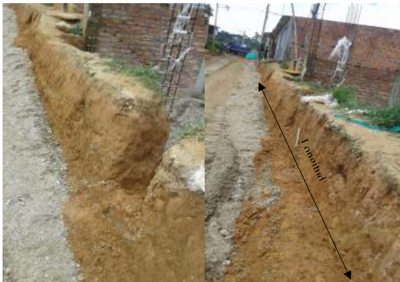
Figura 37. Riesgo de deslizamiento de talud, pavimentación Brisas del Polaco.
