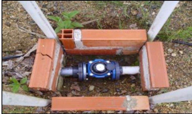
Fotografía 9. Medidor de caudal de agua cruda.
