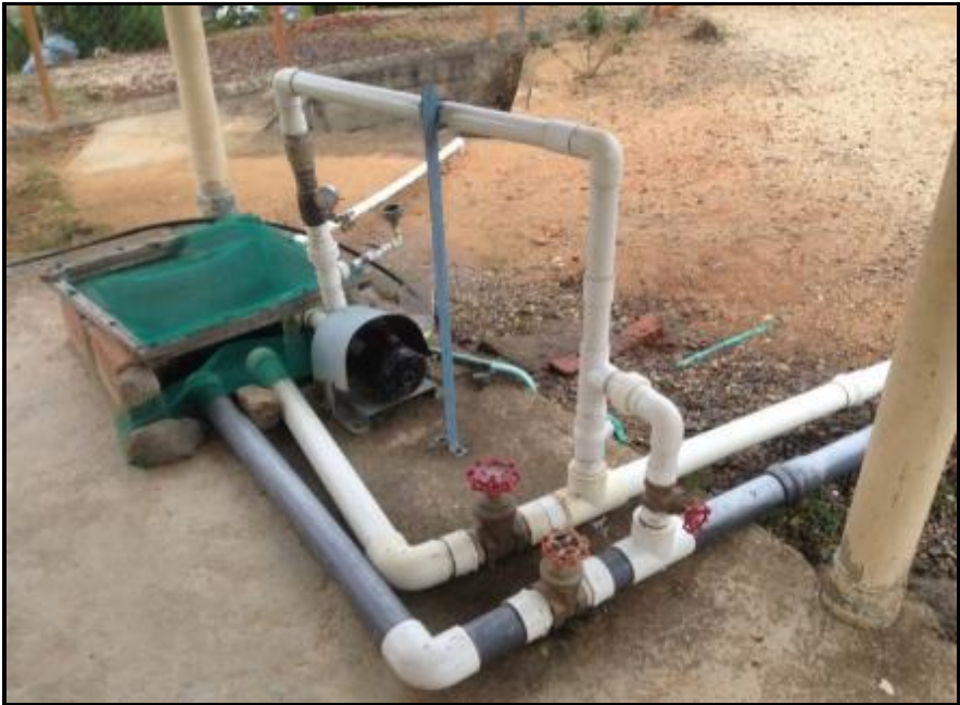
Fotografía 11. Adición de cal y sulfato de aluminio a la tubería de entrada.
