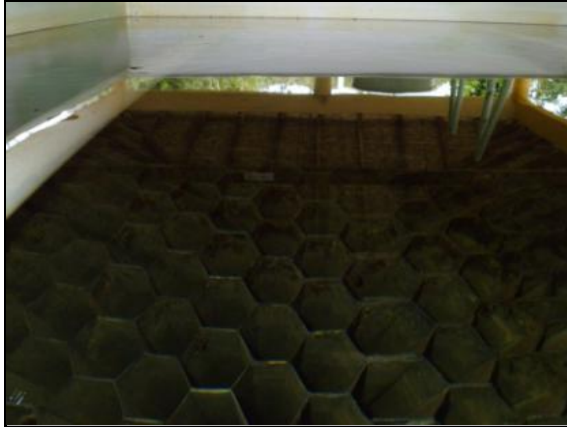
Fotografía 13. Paneles de sedimentación.
