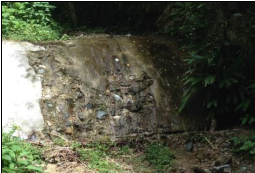
Fotografía 6. Estructura de captación en la Quebrada La Toma
