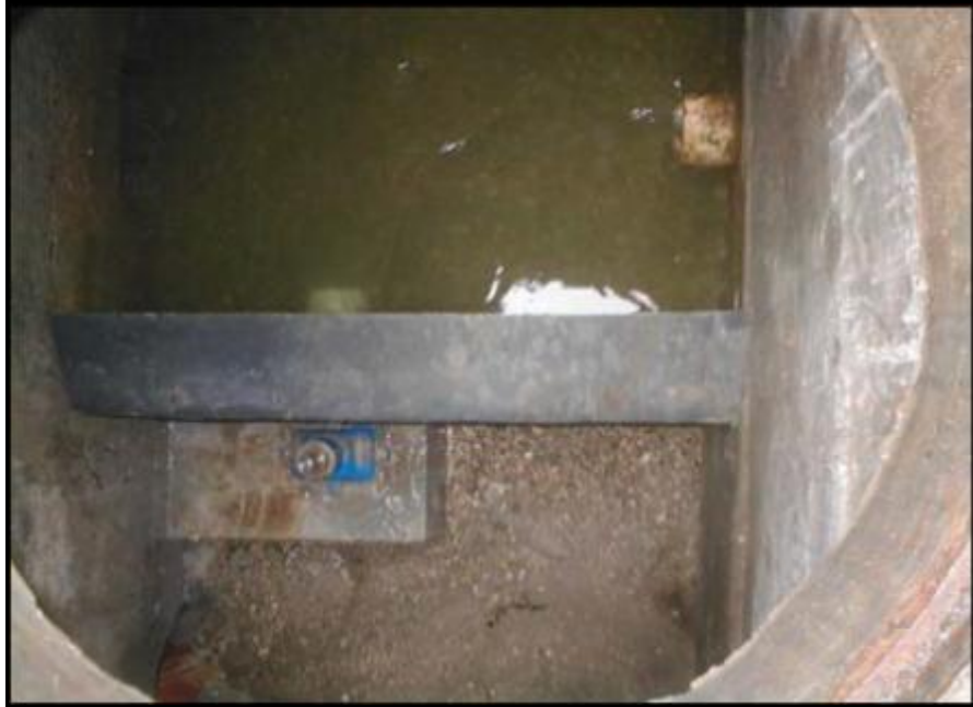
Fotografía 5. Cámara de recolección ubicada en la Quebrada La Toma
