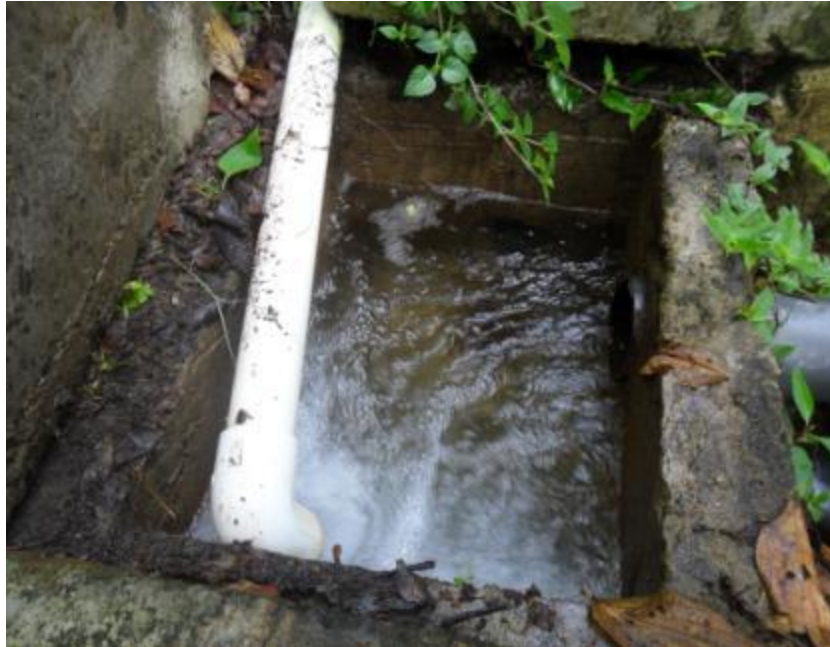
Fotografía 2: Tubería de 3” de reboce del desarenador y de salida en 4”.
