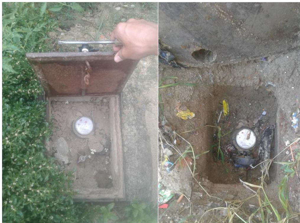
Figura 21. Cajas en mal estado.
