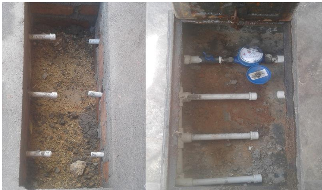
Figura 16. Acometida con el servicio en corte.
