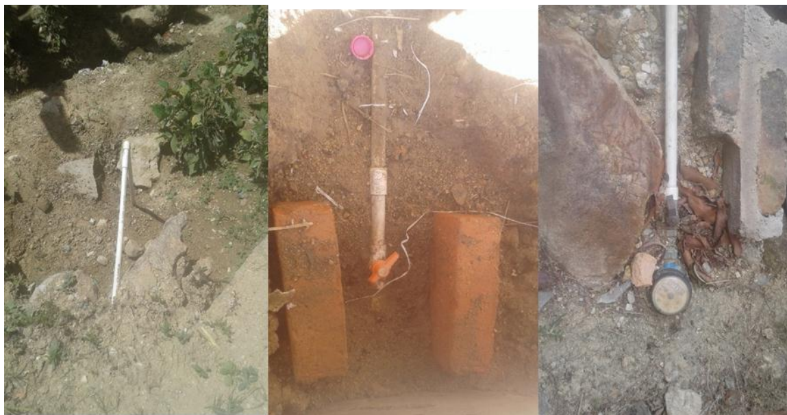
Figura 22. Acometidas sin caja de andén.
