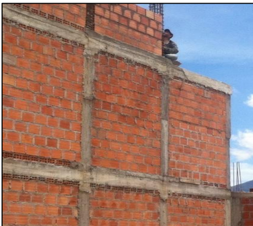
Figura 213. Trabajo en alturas sin ningún implemento de seguridad.
