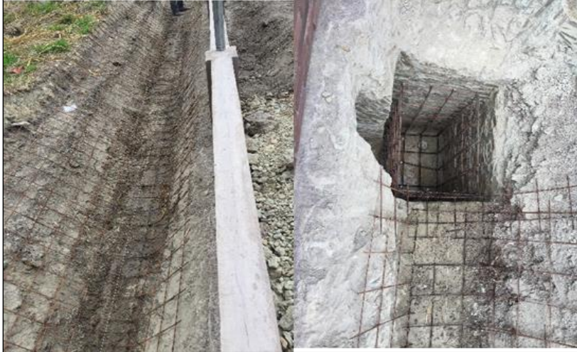
Figura 149. Colocación de malla en el canal y armado de parrilla en la caja.
