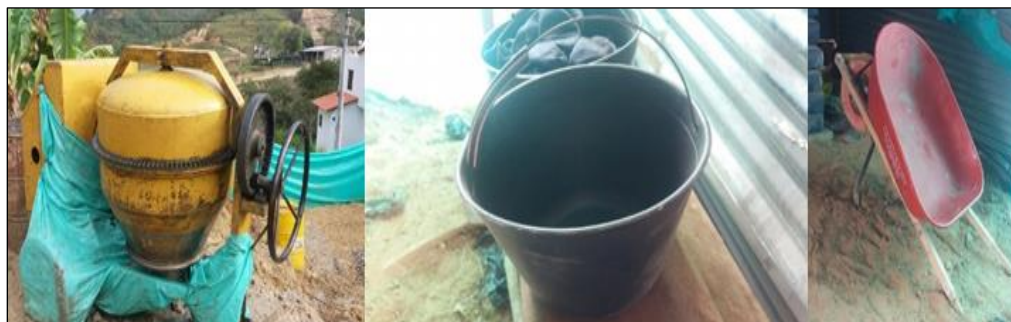
Figura 34. Equipos totalmente limpios antes de su uso.
