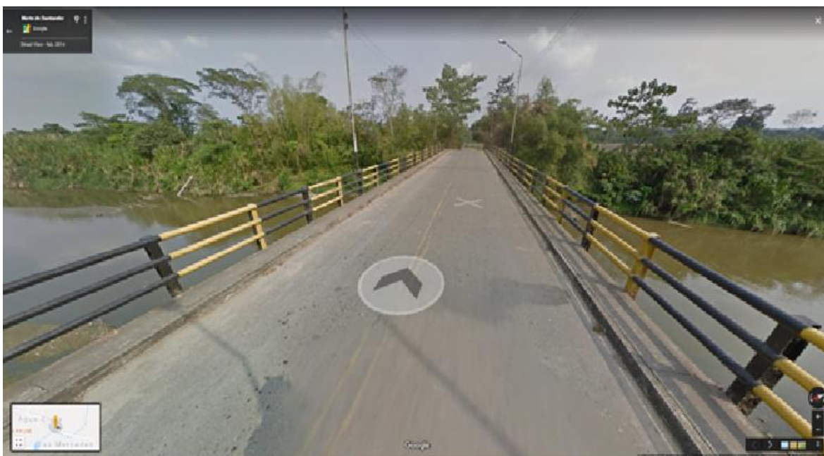
Figura 4. registro fotográfico de localización y estado actual del puente agua clara sobre el rio pamplonita
