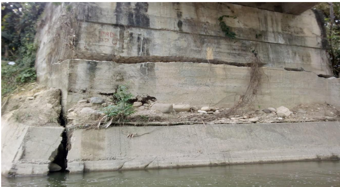
Figura 7. registro fotográfico de localización y estado actual del puente agua clara sobre el rio pamplonita
