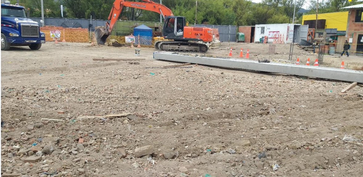
Figura 15 Plataforma Inadecuada Proyecto ALAMEDA 170 II
