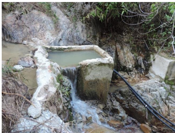
Figura 2. Tanque, captación artesanal Quebrada Las Liscas (2019). Autores.
