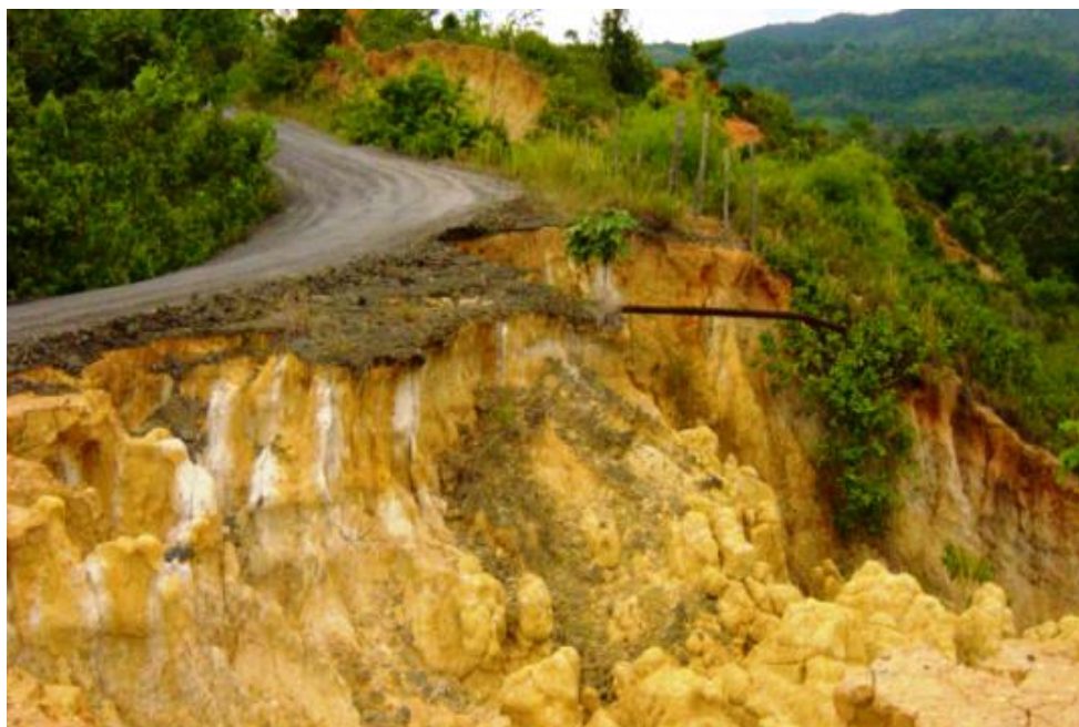
Figura 2. Falla de una sección de relleno. Fuente: Suárez, J. (2011).
