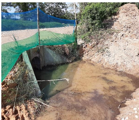
Figura 34. Empozamiento de agua en obra de drenaje pr 63. Autor, 2019.
