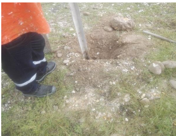
Figura 32. Mejoramiento de anclaje del poste. Autor, 2019.
