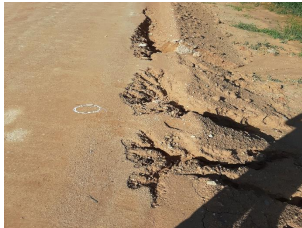
Figura 59. Segregaciones de hombro a causa de la lluvia Autor, 2019.
