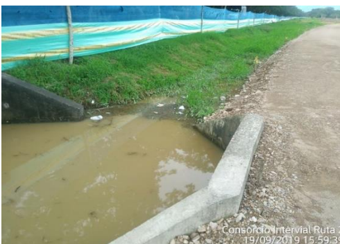
Figura 11. Empozamiento de aguas lluvias en las obras de drenaje en el pr+ 77 foto. Autor, 2019.
