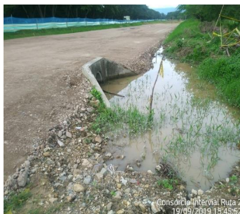
Figura 12. Empozamiento de aguas lluvias en las obras de drenaje en el pr +77. Autor, 2019.
