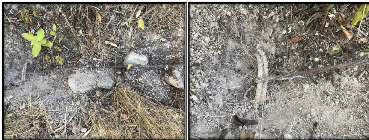
Figura 57. Anclaje presente en los cruces aéreos. (2019) Obtenido de Autor.
