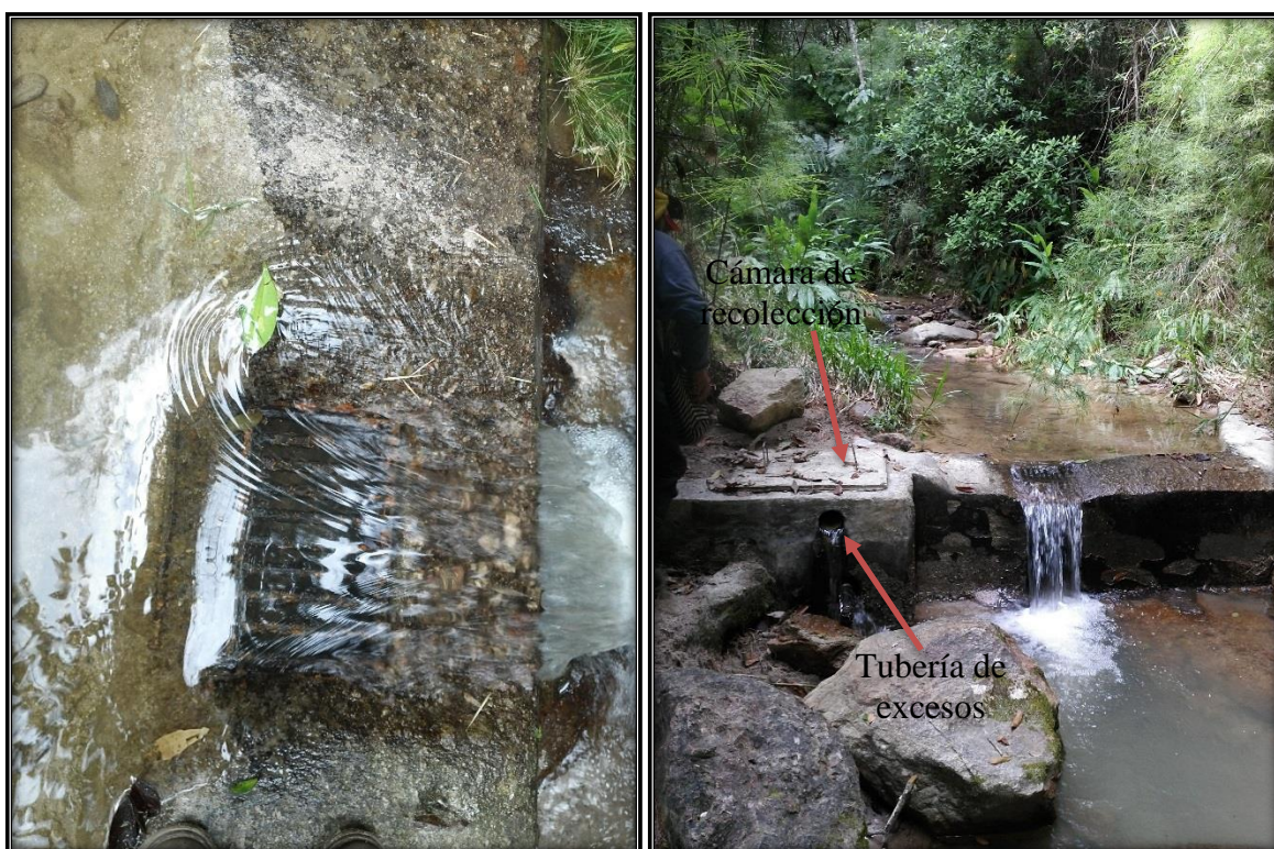
Figura 7. Bocatoma de rejilla de Fondo. (2019) Obtenido de Autor.
