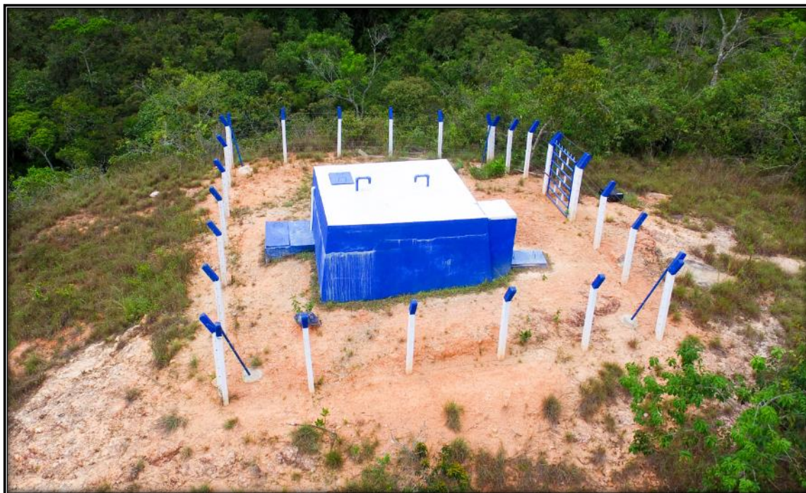
Figura 22. Tanque de almacenamiento existente (2019) Obtenido de Autor.
