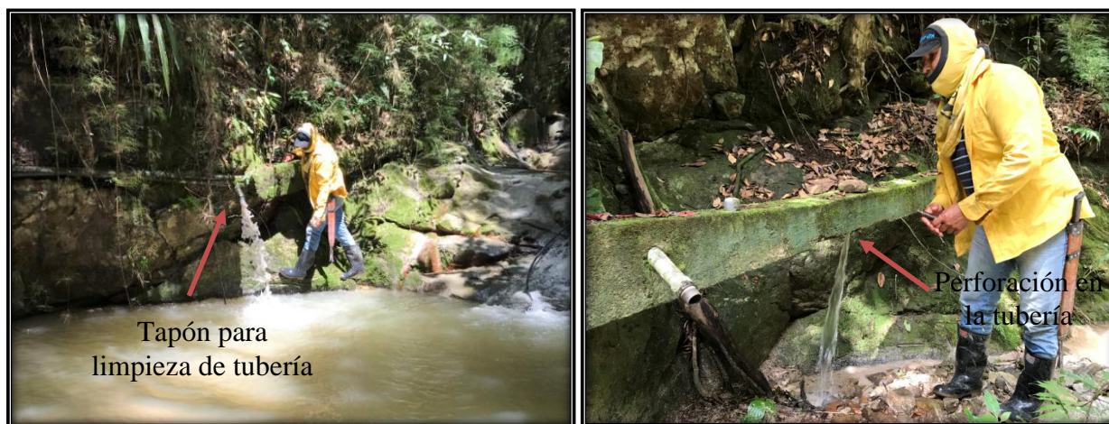
Figura 12. Línea de aducción (Bocatoma – Desarenador). (2019) Obtenido de Autor.
