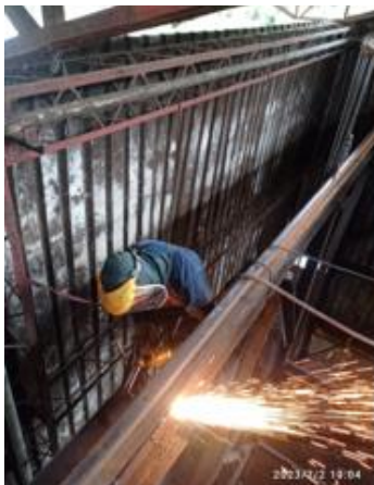
a. Corte de rieles con desgaste.
