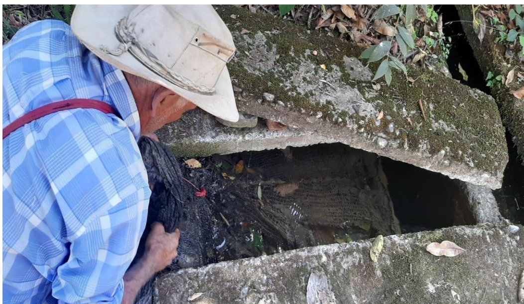
Ilustración 24. Imagen del desarenador en mal estado.
