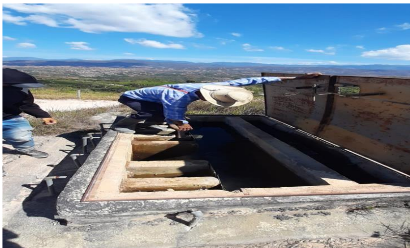
Ilustración 26. Tanquillas del desarenador.
