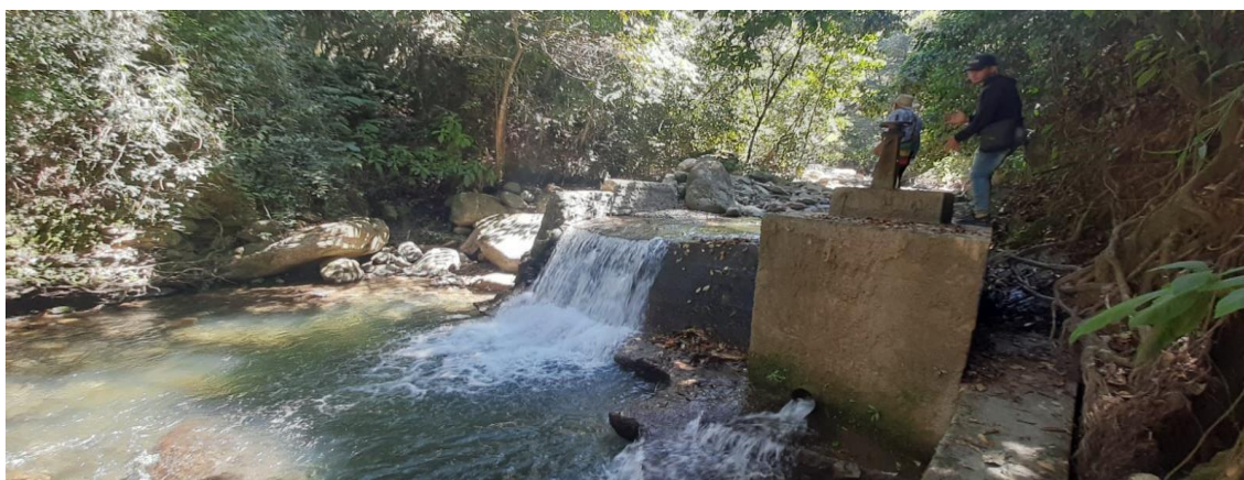
Ilustración 22. Bocatoma. Tomada por autores.
