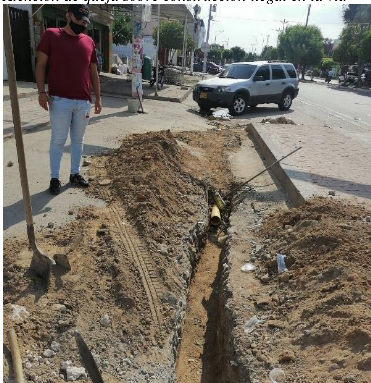
Figura 6: Atención de queja sobre construcción ilegal en la vía
