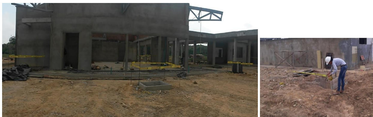
Img. 38 Señalización de cajas de inspección y pequeñas excavaciones en frentes de obra
