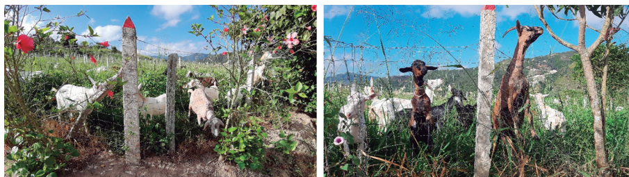
Figura 23. Las cercas utilizadas en praderas se deben diseñar para soportar el peso de los animales, brindando seguridad adecuada. En este caso, con el uso de postes de cemento y malla de alambre galvanizado
