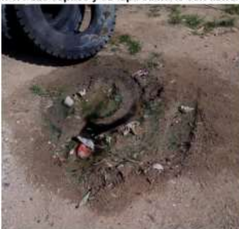
Imagen 4. Pozo séptico y su tapa cubierta con tierra y lodo.
