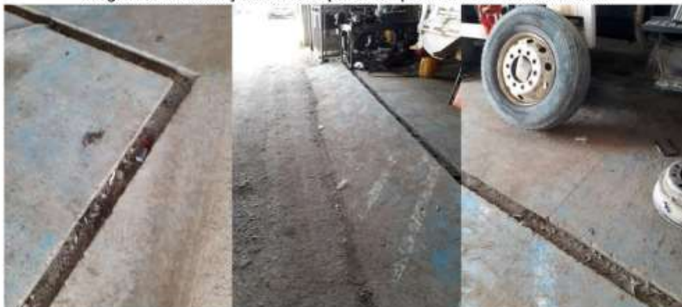
Imagen 12. Suciedad y residuos dispersos en plataforma de mantenimiento.
