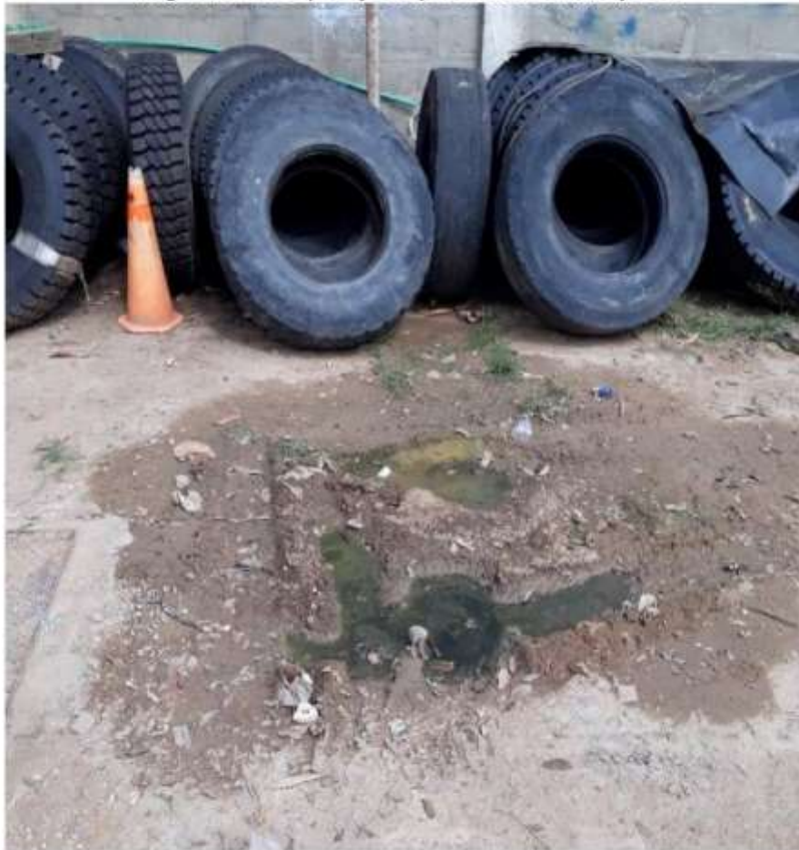
Imagen 17. Pozo séptico y su tapa cubierto con tierra y lodo.
