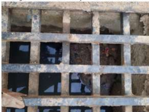
Imagen 2. Alcantarillas con presencia de escombros.
