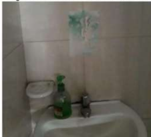
Imagen 10. Señales de sensibilización en mal estado.
