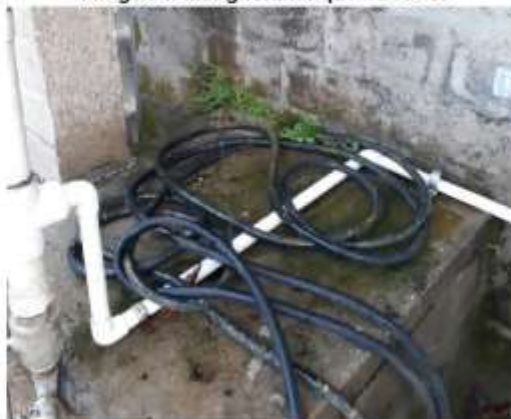
Imagen 4. Manguera tanque elevado.
