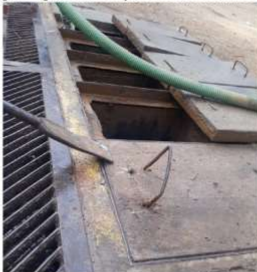
Imagen 1. Agarraderas de tapas de concreto en mal estado .
