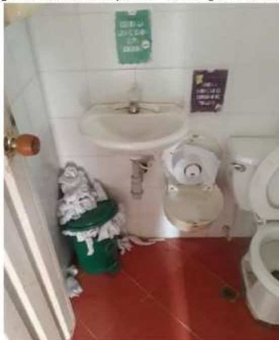
Imagen 10. Contenedor temporal de residuos higiénicos rebozados .
