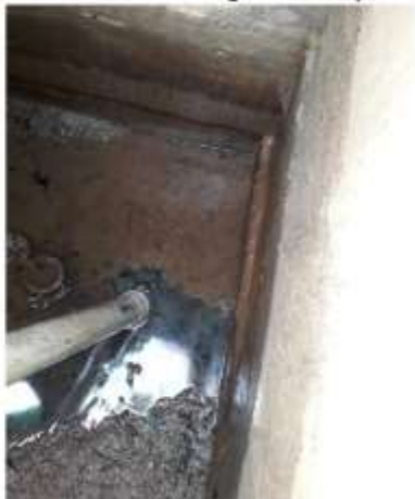
Imagen 16. Contenedor de agua tratada por la trampa.
