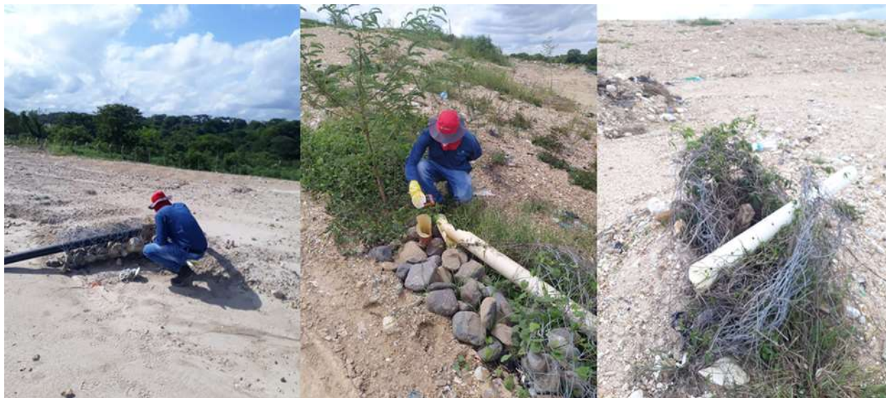
Figura 17. Collage fotográfico de chimeneas caídas y obstruidas. Autor, 2020.
