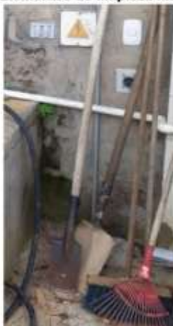
Imagen 2. Elementos de limpieza mal ubicados.
