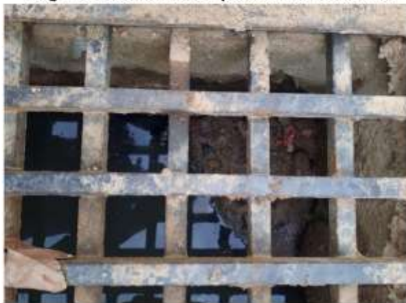
Imagen 15. Alcantarillas con presencia de escombros.
