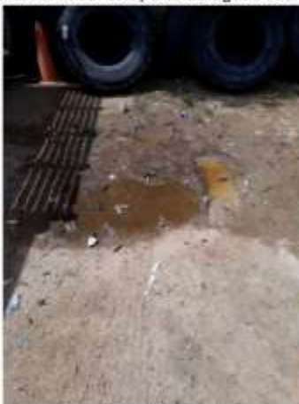
Imagen 7. pozo séptico o contenedor temporal de aguas residuales cubierto por fango.
