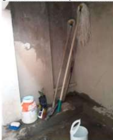
Imagen 9. Elementos de limpieza mal ubicados.
