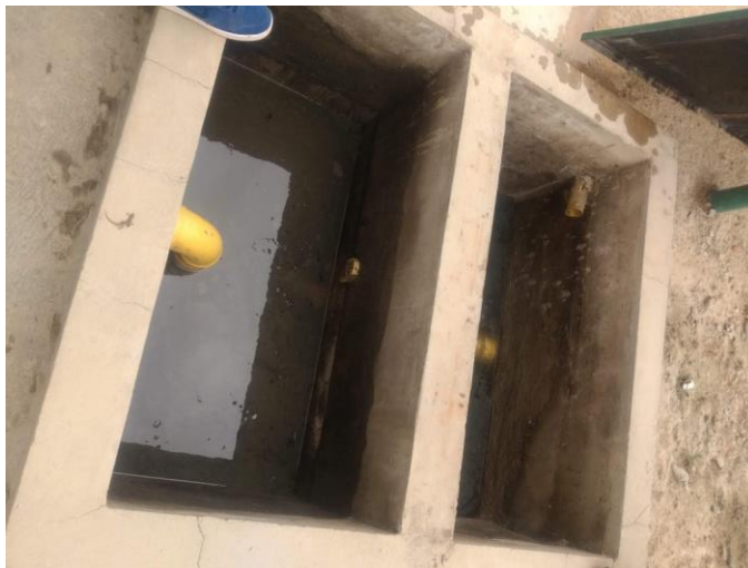
Figura 15. Tanque de almacenamiento. Autor del proyecto
