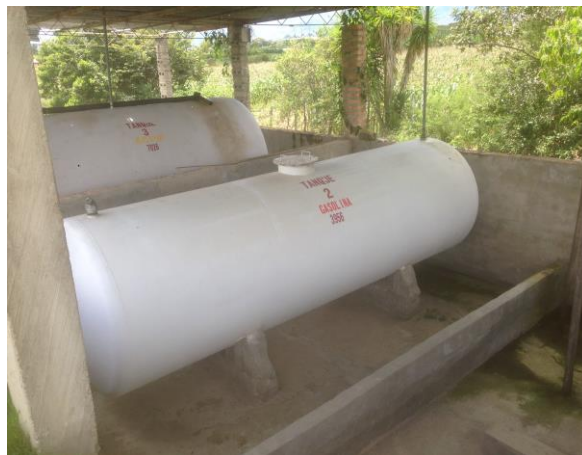
Figura 9. Tanques de almacenamiento. Autor del proyecto.
