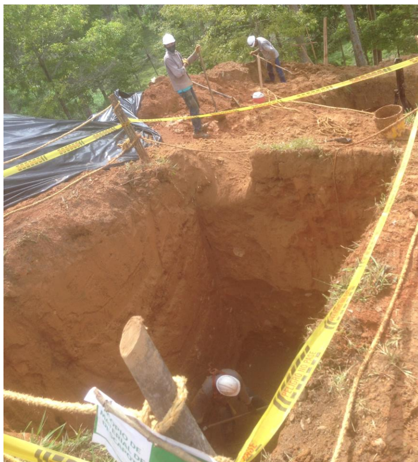
Figura 30. Cerramiento del sitio de trabajo e implementación de equipos de protección personal. Autor del proyecto.
