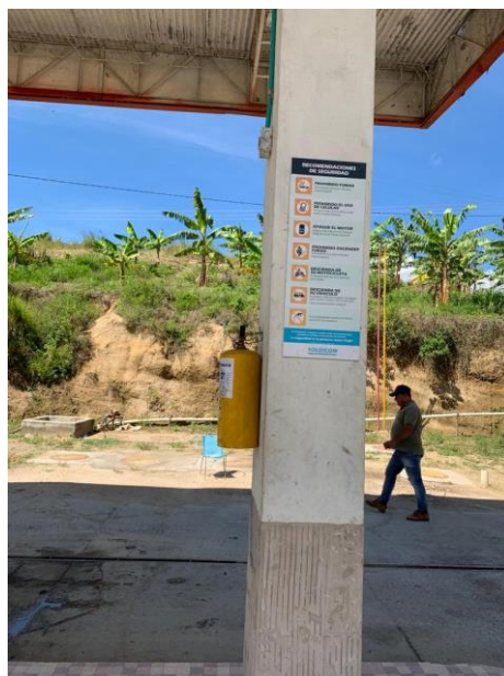
Figura 16. Extintores y elementos de protección. Autor del proyecto.
