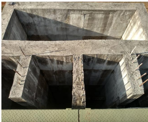
Figura N° 19. Estructura de filtrado. Pasante
