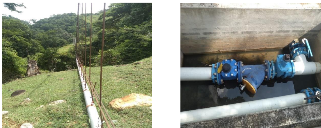
Figura N° 15. Tubería PVC. Aducción desarenador-PTAP. Pasante
