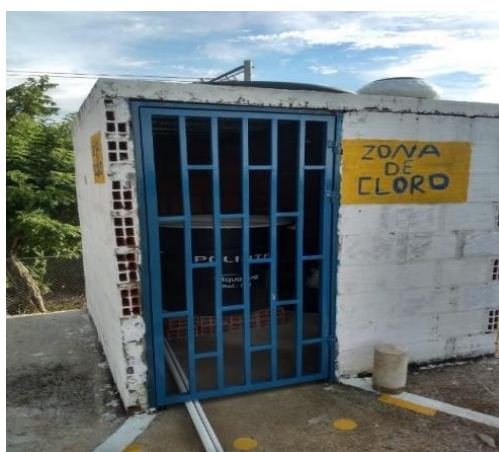
Figura N° 20. Caseta de cloración. Pasante
