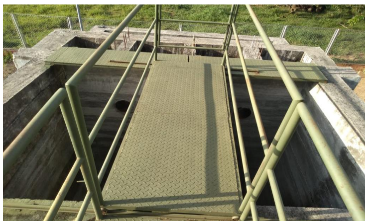
Figura N° 18. Tanques sedimentadores. Pasante
