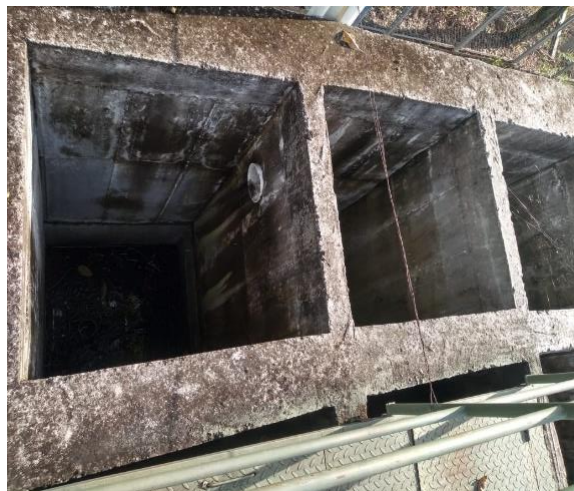
Figura N° 17. Tanques floculadores. Pasante
