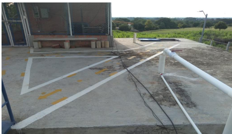
Figura N° 21. tanque de almacenamiento 2. Pasante
