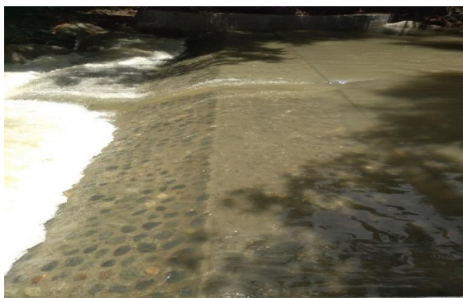
Figura N° 13 Captación de fondo de agua superficial. Pasante
