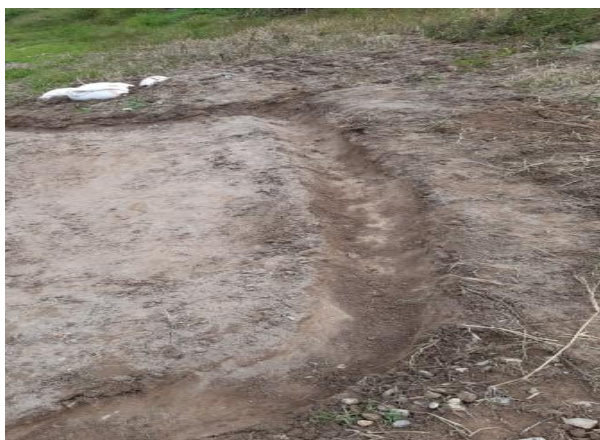
Imagen 15, zanja de coronación para re direccionar las aguas lluvias y del regadío de los cultivos en la parte alta. Fuente: (Autores de proyecto)
