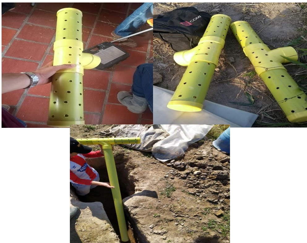
Imagen 5. tubería de desagüe de 4 pulgadas en forma de t con perforaciones de 8 ml de diámetro. Fuente: (autores del proyecto)
