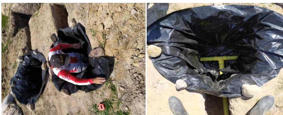
Imagen 6. Geo membrana y Sistema de desagüe de los filtros de la primera y segunda etapa. Fuente: (autores del proyecto).
