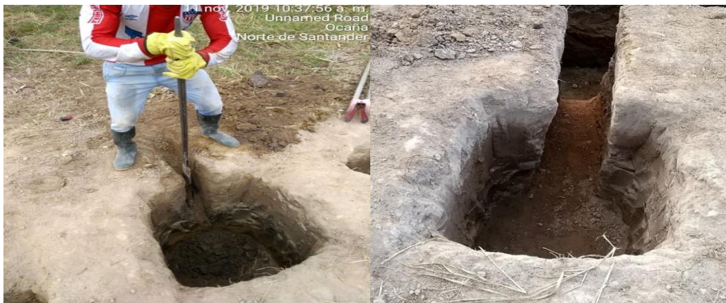
Imagen 2. Zanjas de los filtros para la tubería de desagüe. Fuente: (autores del proyecto)
