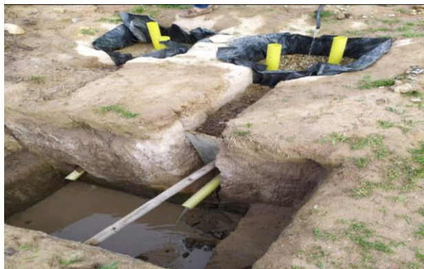
Imagen 9. Fase de prueba del sistema de desagüe del sistema piloto. Fuente: (autores del proyecto).
