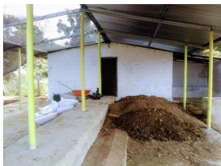
Figura 20. Estado de la zona de almacenamiento de tierra del vivero el Edén. (2021).
