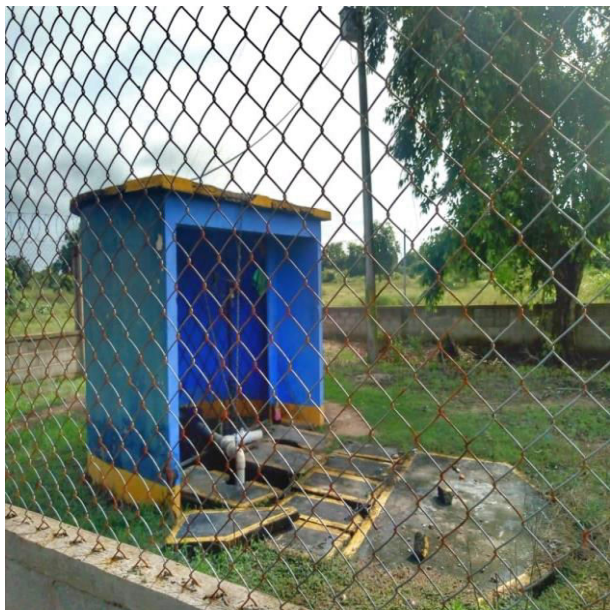
Figura 27 Entrada de las aguas residuales al sistema de tratamiento. (colector) Fuente: Autores (2020)
