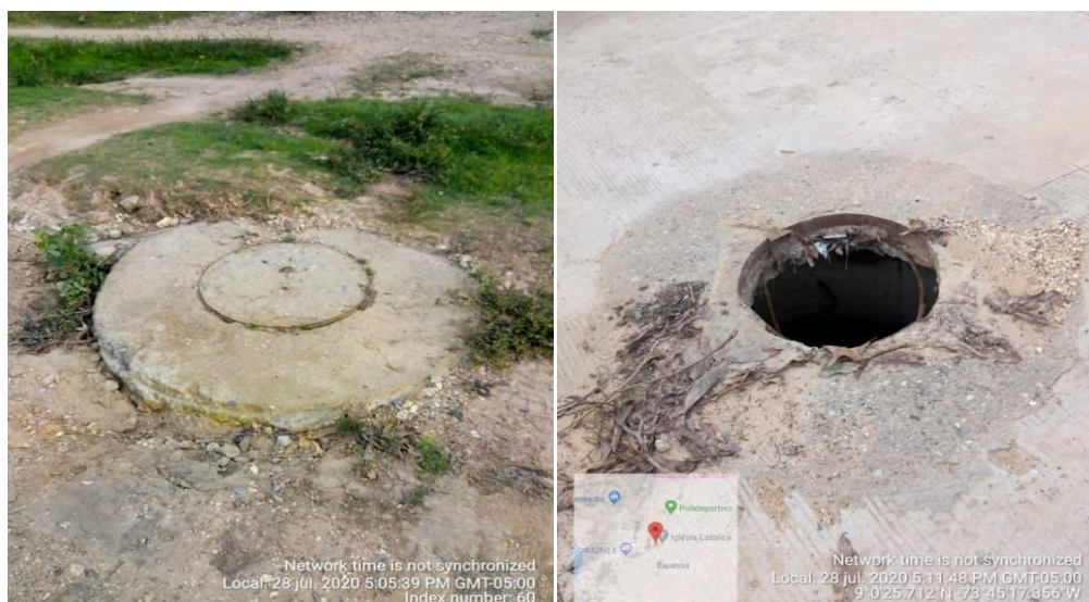
Figura 14. Evidencia alcantarillas en mal estado.
