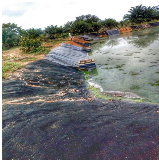
Figura 29 Cámaras de entrada agua residual a la laguna de oxidación. Fuente: Autores (2020)
