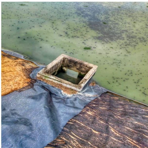
Figura 30 Cámara de entrada agua residual a la laguna de oxidación. Fuente: Autores (2020)
