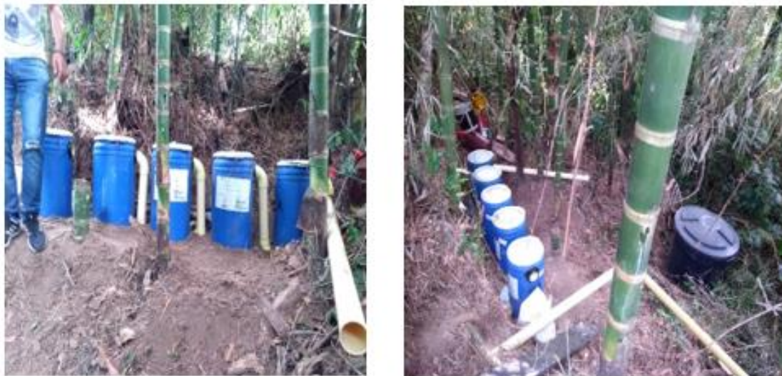
Figura 17. Diseño y construcción para la implementación del sistema piloto para el tratamiento de las aguas residuales
