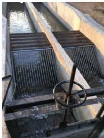
Figura 12. Rejillas para detener residuos solidos
