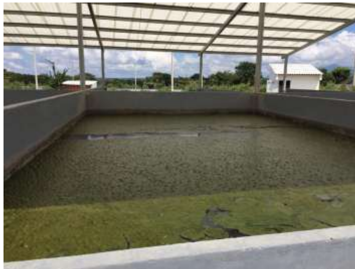
Figura 27. Lodo liquido proceso de Espesado por flotación
