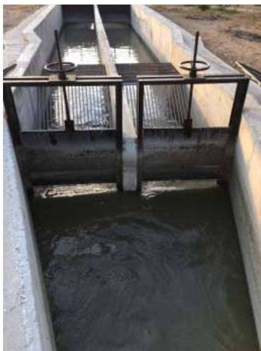
Figura 11. Rejilla para disminución del caudal
