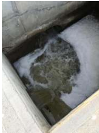
Figura 20. Desembocacion de agua tratada
