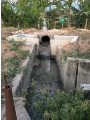
Figura 9. Desembocacion de las agua negra y agua de lluvias
