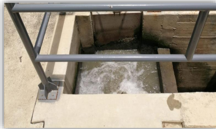
Figura 7. Caja de Entrada Fuente: Autores del proyecto, 2019
