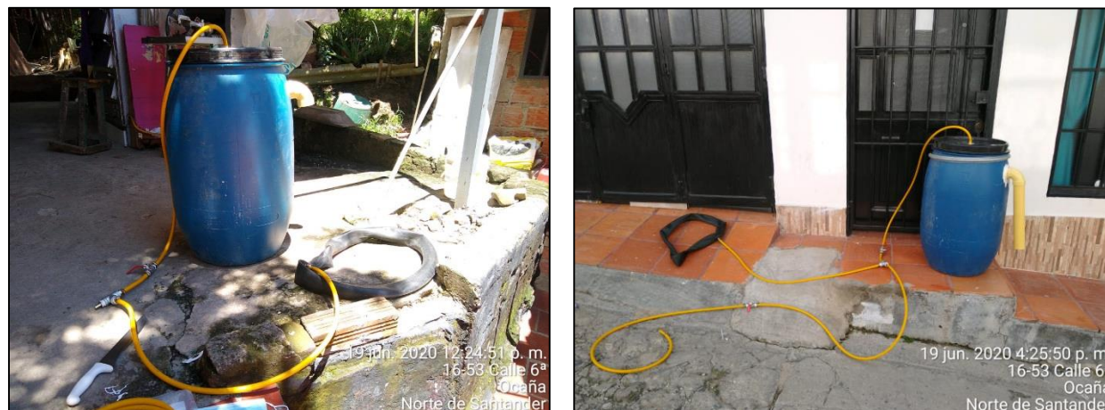
Figura 20. Acople entre digester, neumático de almacenamiento y quemador. Autores, 2020.
