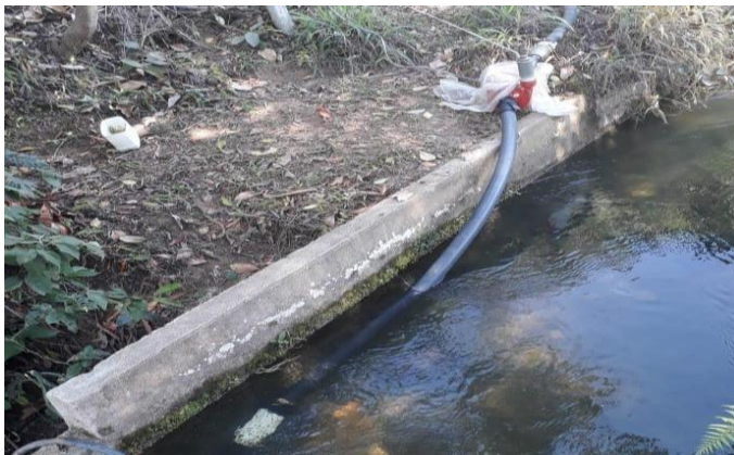
Figura 38. Método del bombeo, utilizado para abastecerse del minidistrito de Rio Frio.
