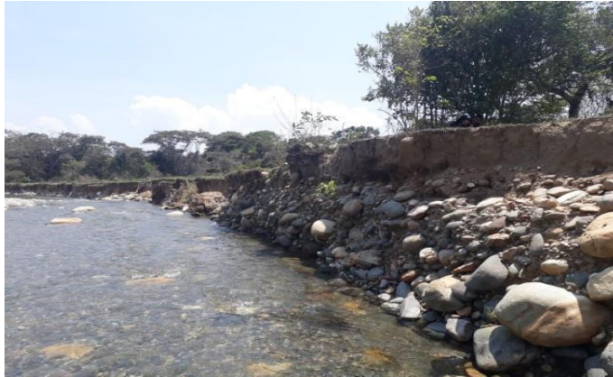
Figura 17. Erosión hídrica por el río Frío
