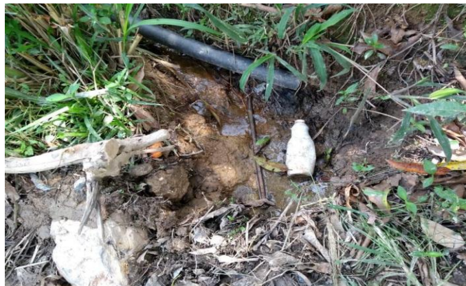
Figura 30. Vertimiento puntual de aguas residuales vereda la Teja.
