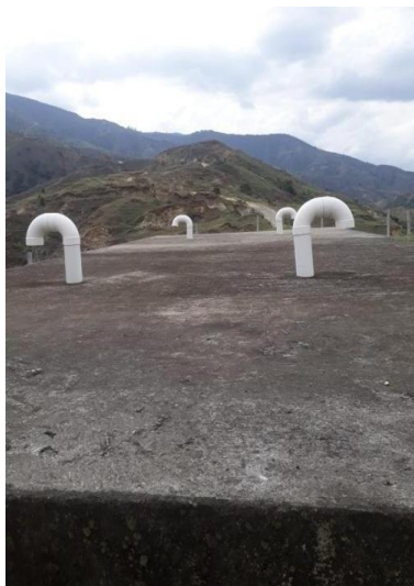
Figura 45. Sistema de aireación del tanque de abastecimiento del acueducto Capitanlargo.
