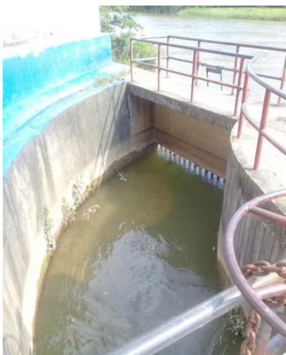
Figura 39. Rejillas del sistema de captación lateral de la vereda Rio Frio
