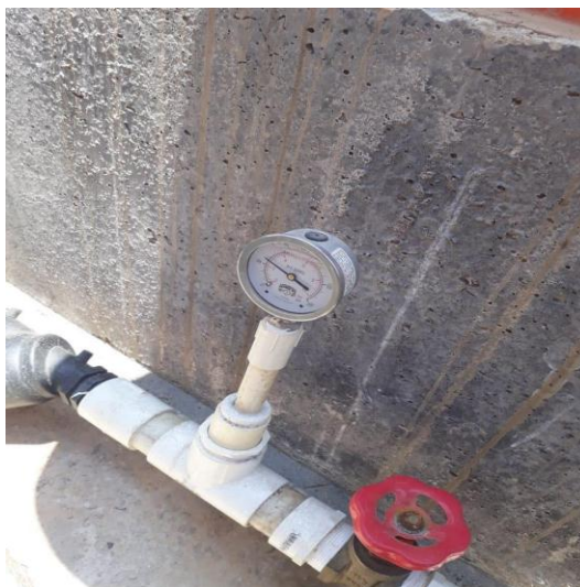
Figura 35. Medidor de presión de la Bomba Hidroneumática.
