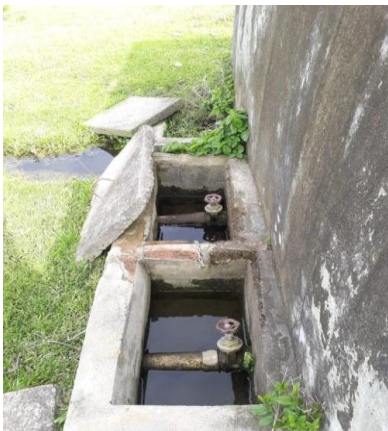
Figura 48. Llaves de paso a la red de distribución, inundadas y oxidadas.
