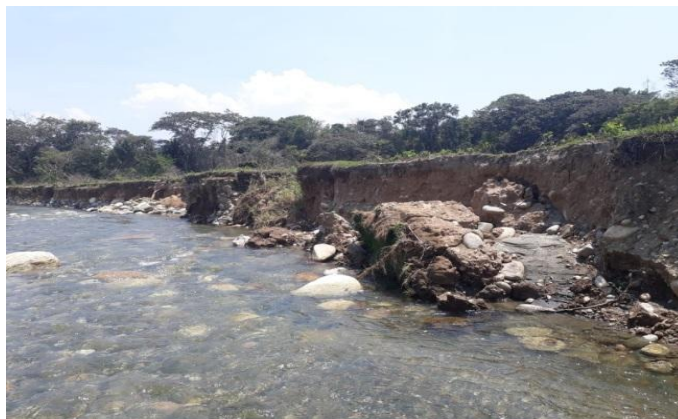
Figura 18. Erosión hídrica por el río Frío
