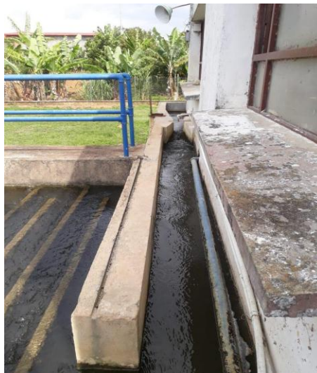
Figura 50. Entrada del agua cruda a la PTAP- Casa de Teja.
