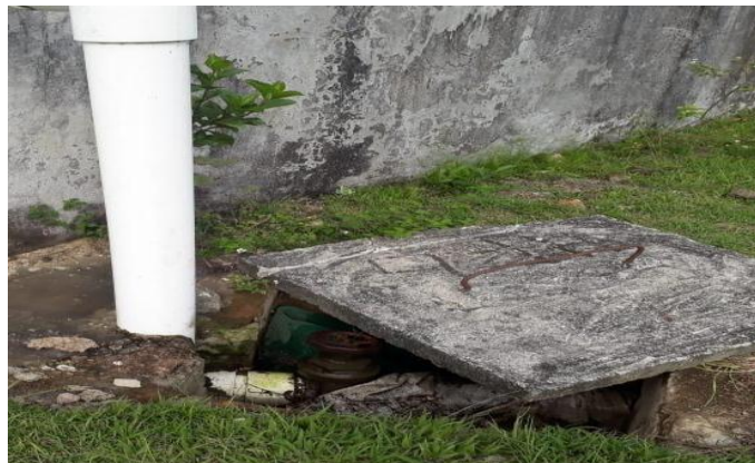
Figura 46. Llave de paso, hacia el tanque de abastecimiento.
