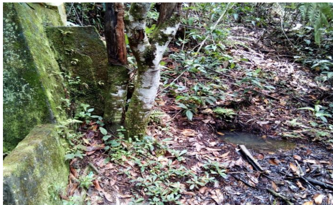
Figura 43. Fuga de agua subterránea del sistema de abastecimiento El Campanario.
