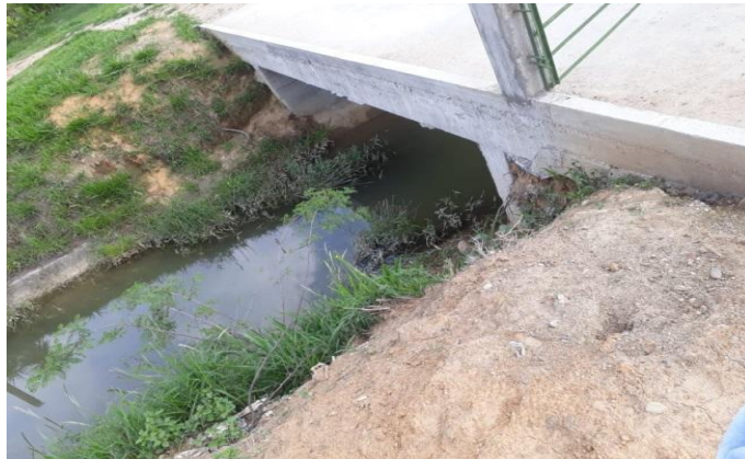
Figura 28. Acumulación de lodos y vegetación en el minidistrito Casa de Teja. Fuente. Autor del Proyecto (2019).
