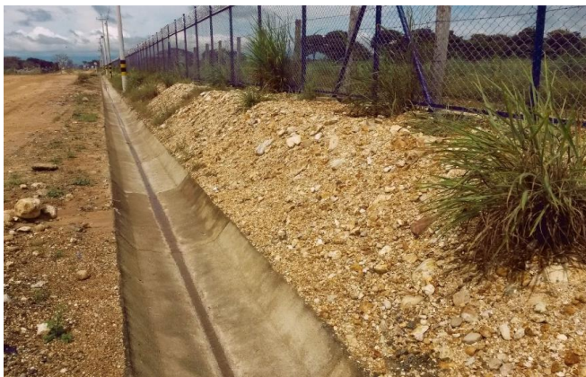
Fotografía 6. Canal perimetral de conducción de agua lluvia y escorrentía.
