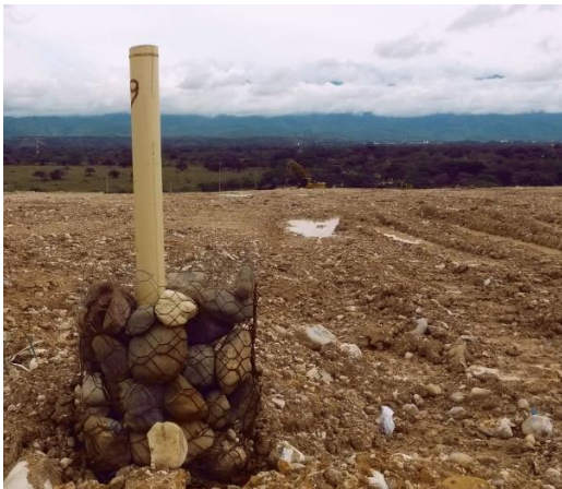
Fotografía 10. Chimenea para la evacuación.
