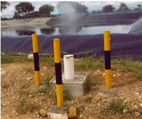
Fotografía 8. Instrumento para medir el nivel de líquidos lixiviados.
