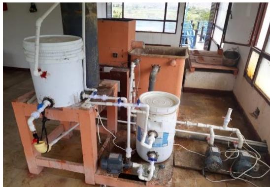
Foto 6. Dosificador no convencional
