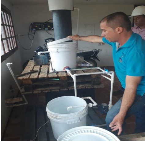
Foto 13. Dosificador no convencional
