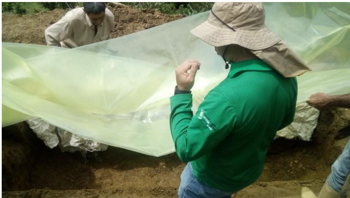
Foto 6. Ubicación del biodigestor
