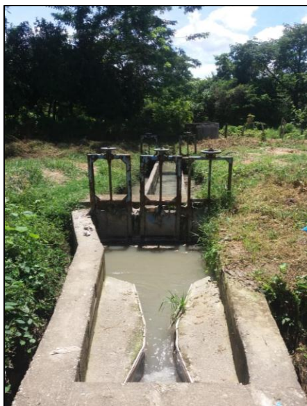
Figura 12. Recepción de aguas residuales sistema de tratamiento de agua residual Curumani Fuente. Pasante del proyecto del proyecto
