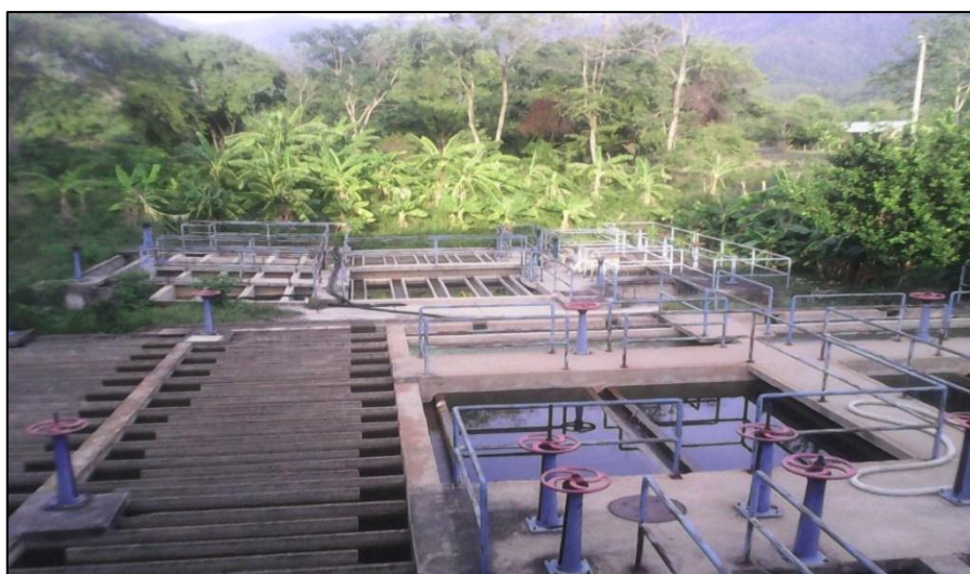
Figura 8. Planta de tratamiento de agua potable Fuente. Pasante del proyecto del Proyecto
