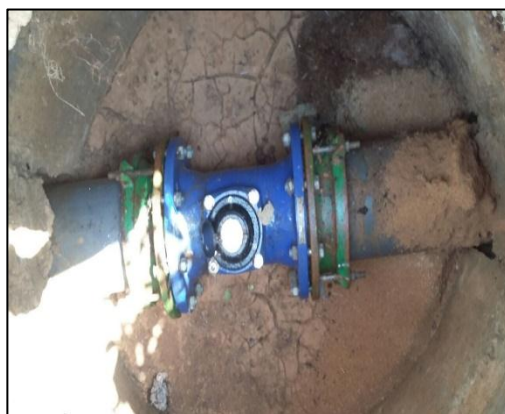
Figura 6. Línea de aducción con su respectiva caja de inspección Fuente. Pasante del proyecto del proyecto
