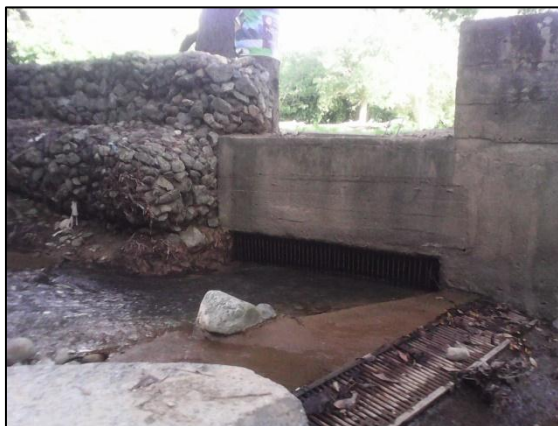
Figura 4. Captación de tipo lateral Bocatoma Quebrada San Pedro Fuente. Pasante del proyecto del proyecto
