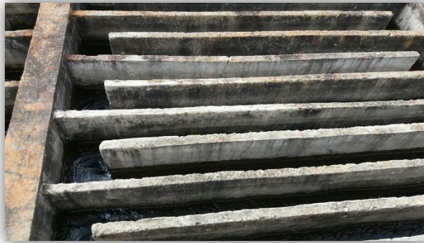
Fotografía 14. Placas de los floculadores. Fuente: Autora de la pasantía.
