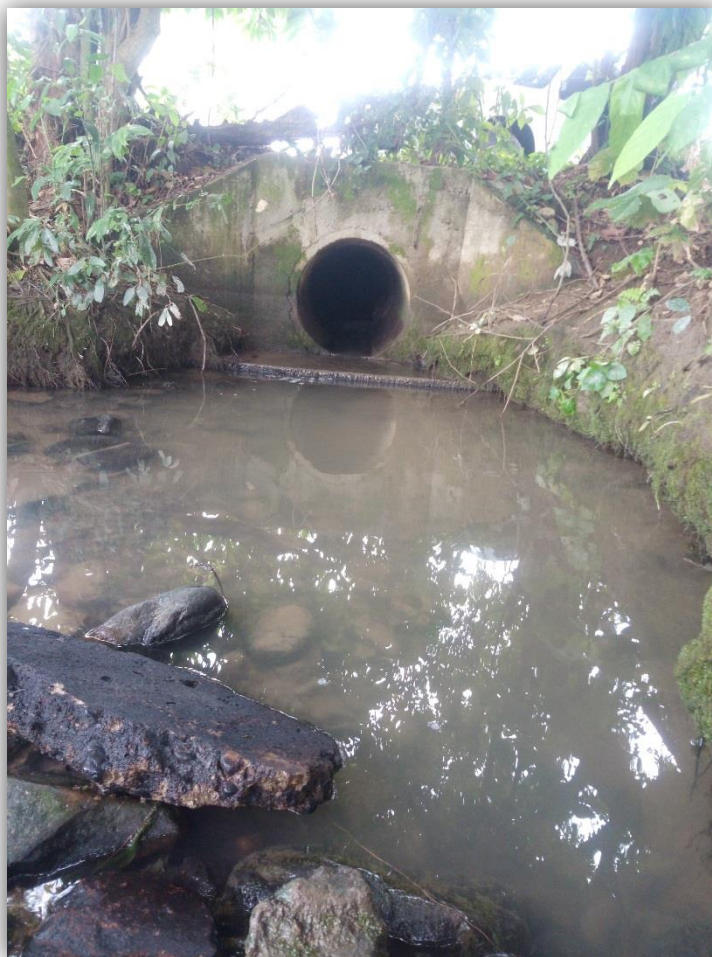
Fotografía 20. Conducto del vertimiento. Fuente: Autora de la pasantía.
