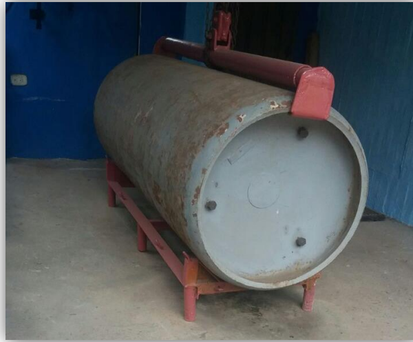
Fotografía 12. Bala de Cloro Gaseoso. Fuente: Autora de la pasantía.
