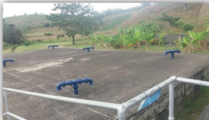
Fotografía 13. Tanques de almacenamiento. Fuente: Autora de la pasantía.
