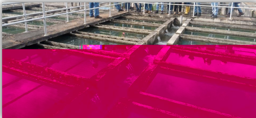
Fotografía 10. Sedimentadores. Fuente: Autora de la pasantía.
