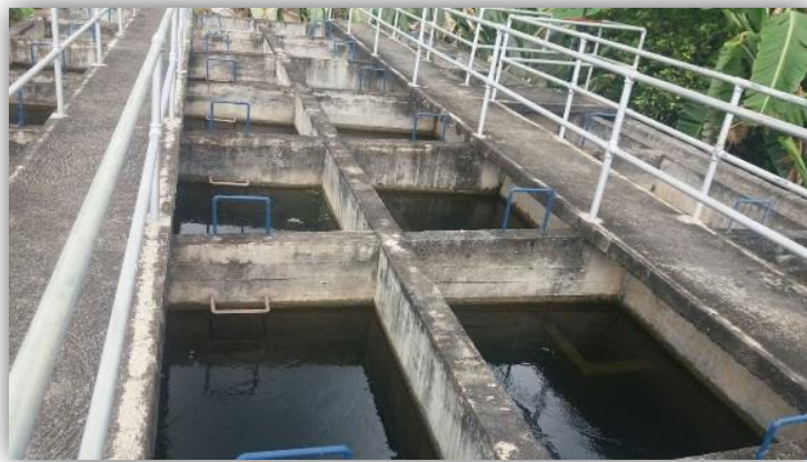
Fotografía 9. Floculadores flujo vertical. Fuente: Autora de la pasantía.
