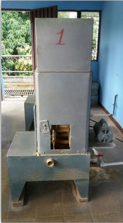
Fotografía 6. Dosificador de Sulfato Aluminio. Fuente: Autor
