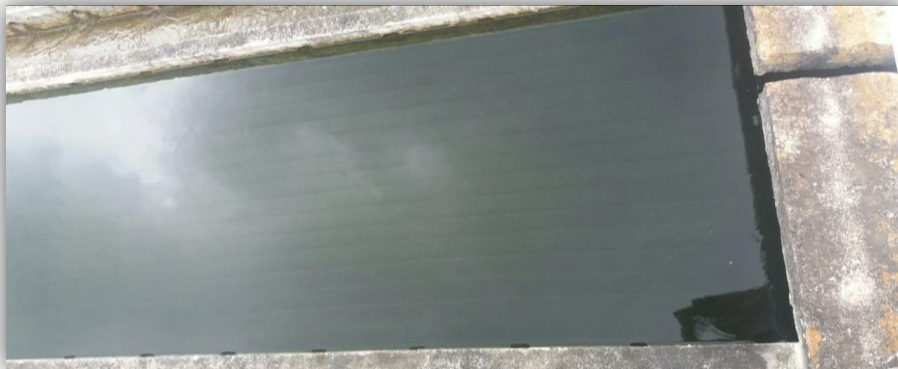
Fotografía 15. Placas de sedimentadores. Fuente: Autora de la pasantía.
