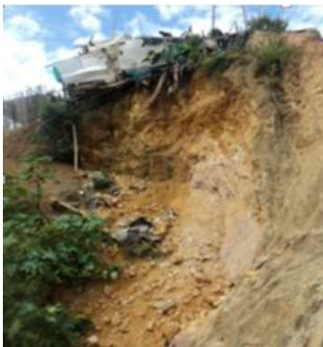
Fotografía 3. Vivienda que presenta riesgo de derrumbarse Fuente. Autoras 2018
