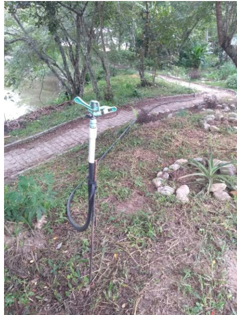
Fotografía 1. Sistema de riego actual
