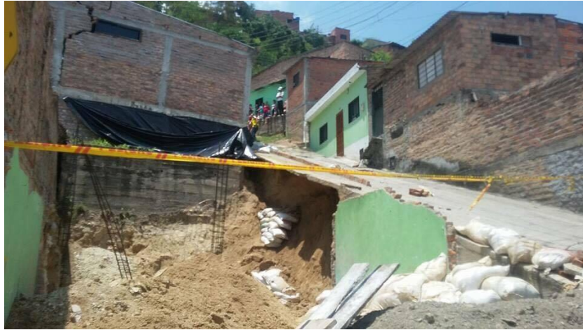
Fotografía 3, Desplome de vía y deterioro de vivienda por construcción inadecuada
