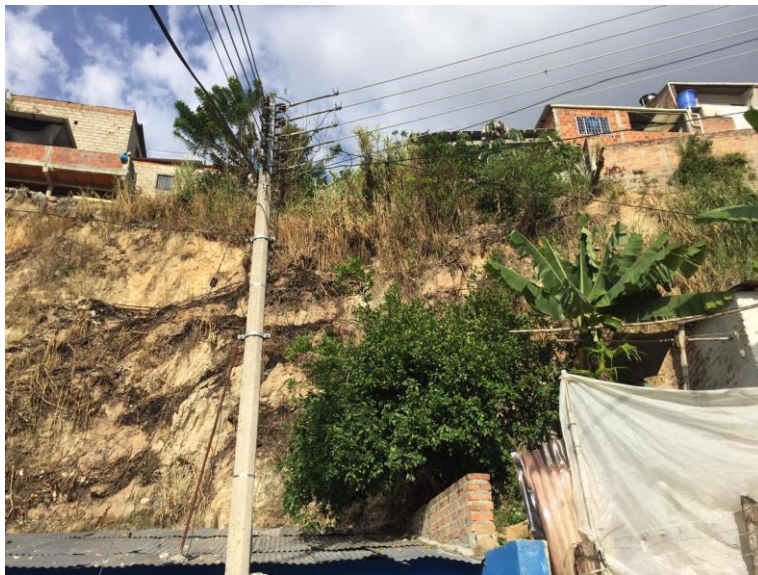
Fotografía 6. Construcciones en zona de alto riesgo, cresta y pie de ladera
