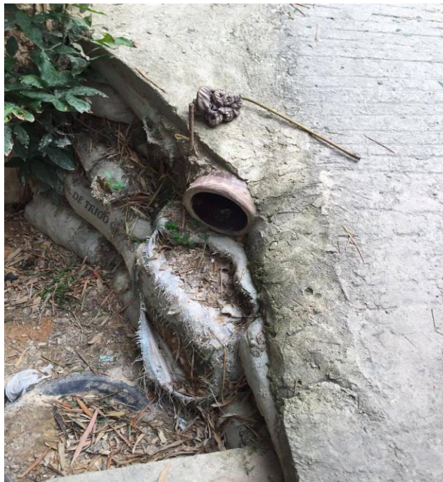
Fotografía 17, Tubería de aguas servidas
