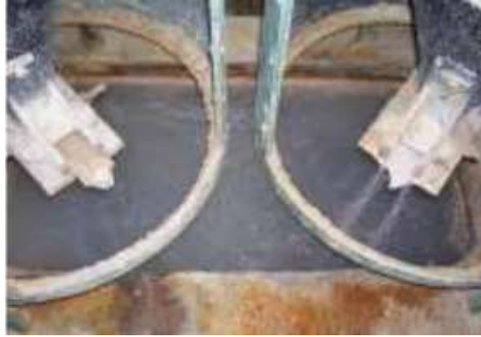
Fotografía 22. Conducción de agua cruda PTAP El Llanito
