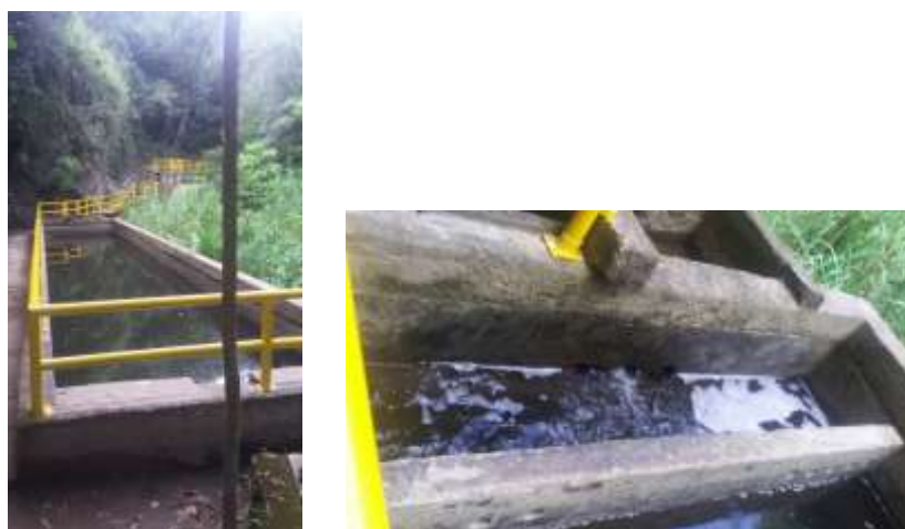
Fotografía 21. Desarenador PTAP El Llanito
