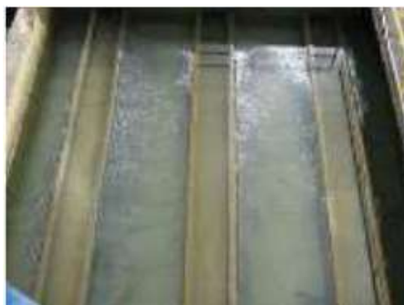
Fotografía 39. Tanque de filtración PTAP Algodonal.
