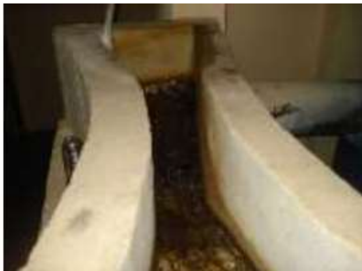
Fotografía 13 Canaleta Parshall ADAMIUAIN
