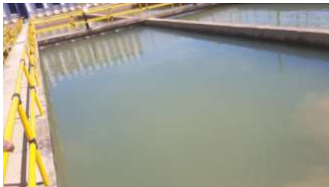
Fotografía 38. Tanques sedimentadores PTAP Algodonal.
