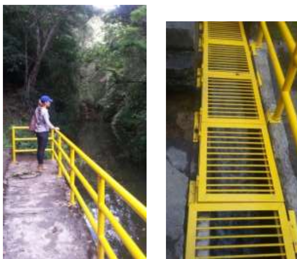
Fotografía 19. Bocatoma ESPO, PTAP El Llanito
