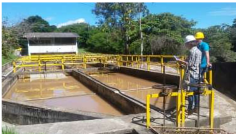
Fotografía 32. Tanques desarenadores PTAP Algodonal
