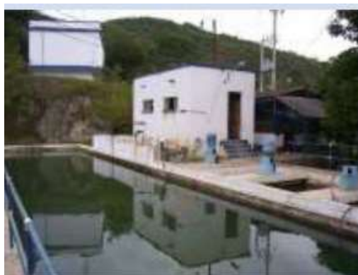
Fotografía 25. Tanque sedimentador PTAP El Llanito
