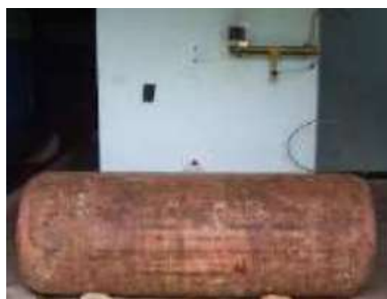
Fotografía 27. Sistema de cloración PTAP El Llanito
