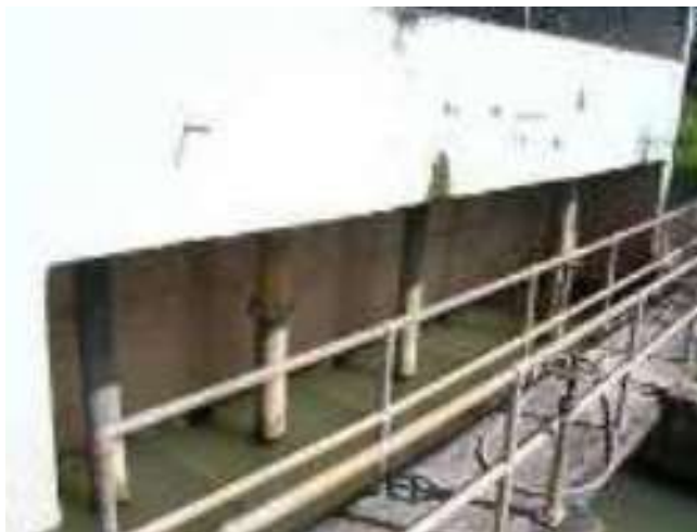
Fotografía 34. Cámara de aquietamiento PTAP Algodonal
