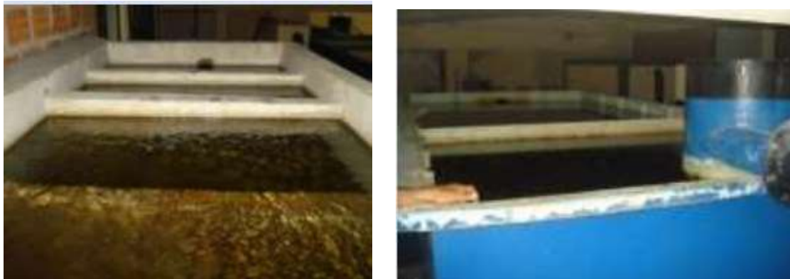
Fotografía 12. Tanques floculadores ADAMIUAIN
