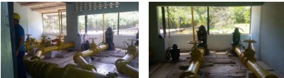
Fotografía 33 Estación de bombeo de agua no tratada PTAP Algodonal.
