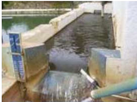
Fotografía 23. Mezcla rápida PTAP El Llanito
