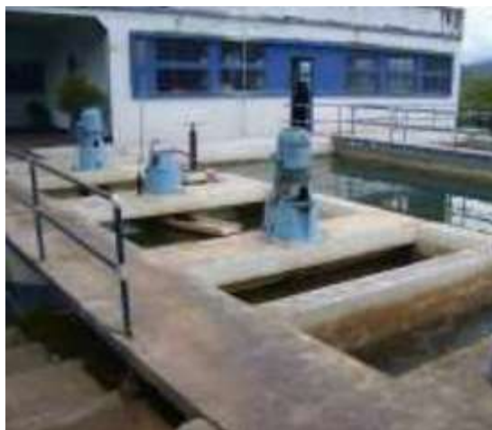
Fotografía 24. Floculador PTAP El Llanito
