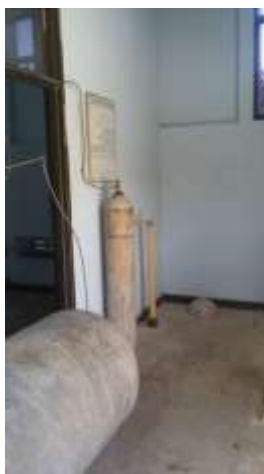
Fotografía 40. Sistema de cloración PTAP Algodonal.
