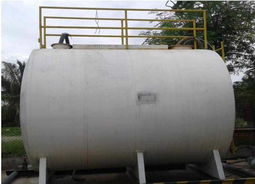
Figura 13. Tanque de almacenamiento de Biosólido PTARI. Fuente: autor de la pasantía.
