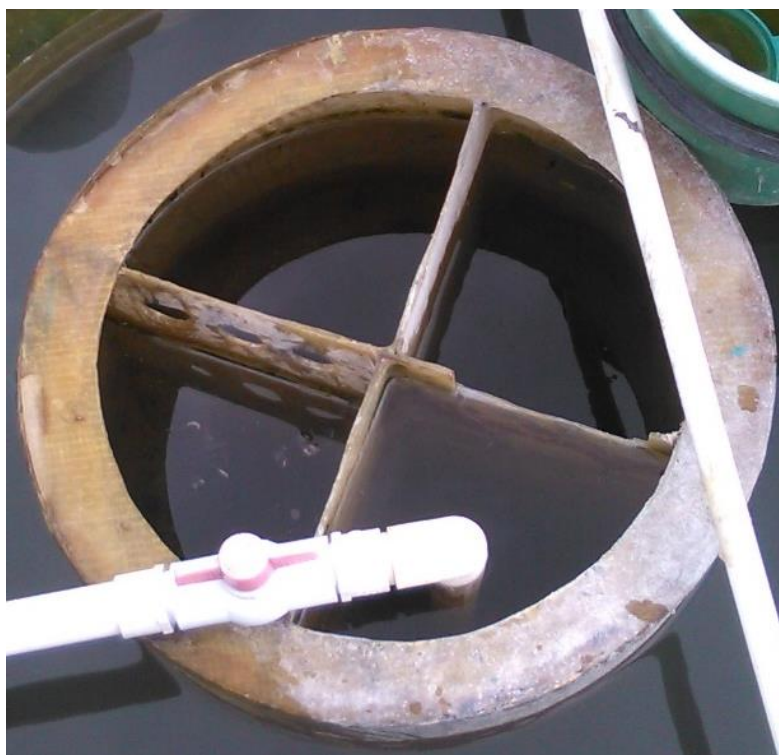
Figura 24. Tanque Floculador STARD. Fuente: autor de la pasantía
