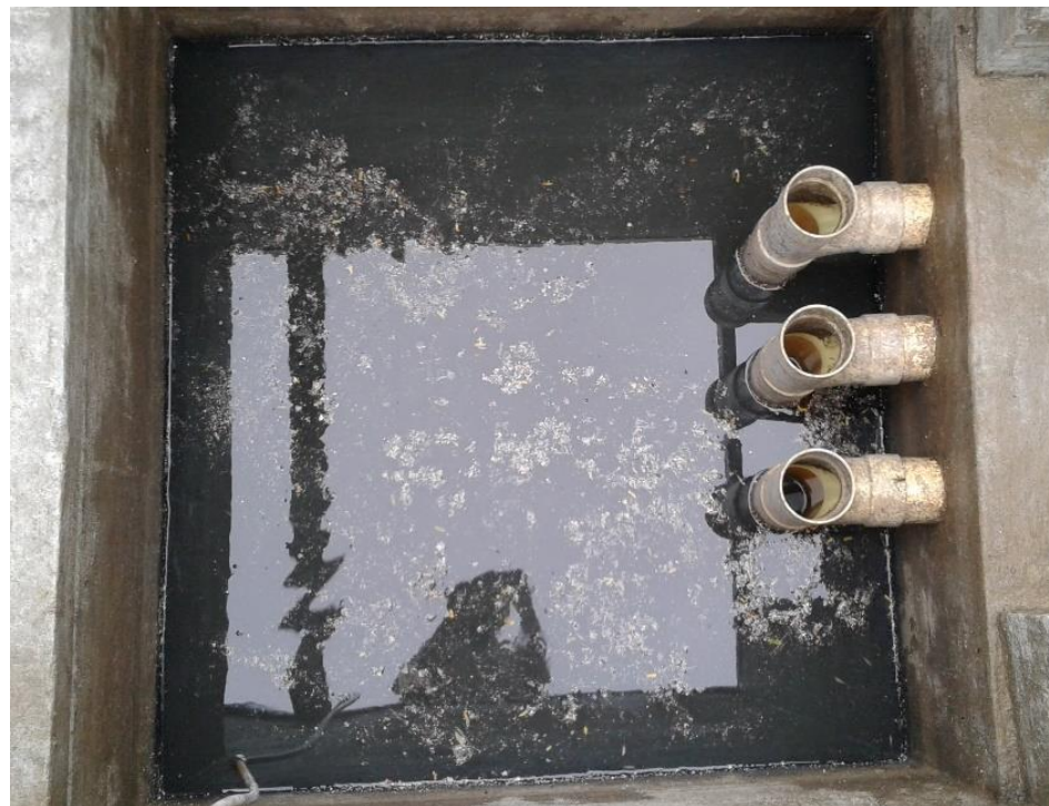
Figura 19. Tanque Sedimentador STARD. Fuente: autor de la pasantía.
