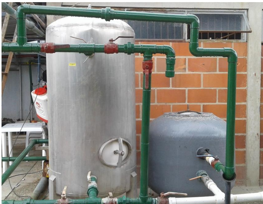
Figura 14. Filtros PTARI. Fuente: autor de la pasantía.
