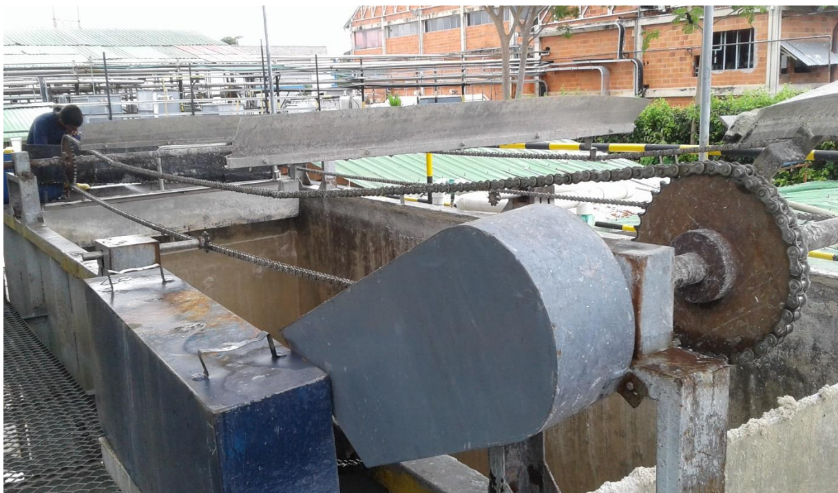
Apéndice 17. Barredor de Biosolidido en el tanque DAF de la PTARI
