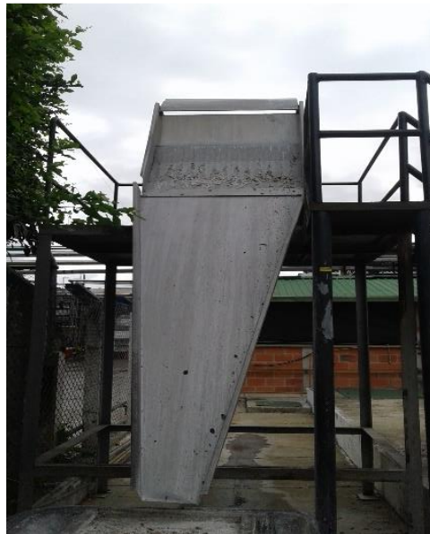
Figura 8. Tamiz empleado en la PTARI. Fuente: autor de la pasantía
