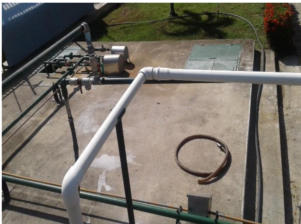
Figura 9. Tanque Homogenizador PTARI. Fuente: autor de la pasantía.
