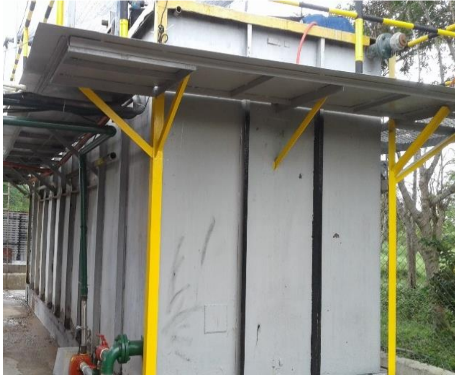
Figura 12. Reactor DAF PTARI. Fuente: autor de la pasantía.
