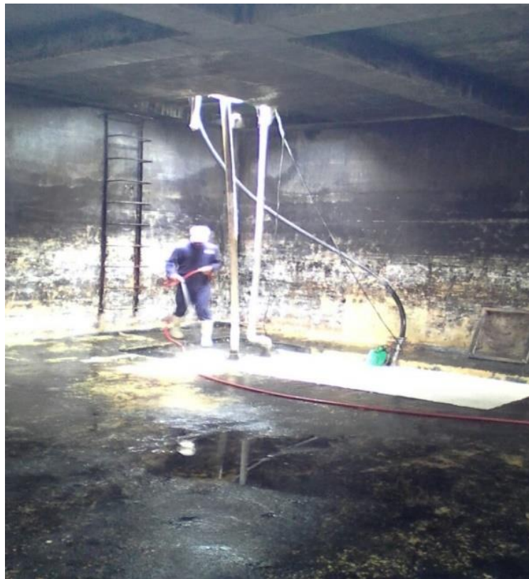
Figura 33. Lavados de tanques PTARI. Fuente: autor de la pasantía
