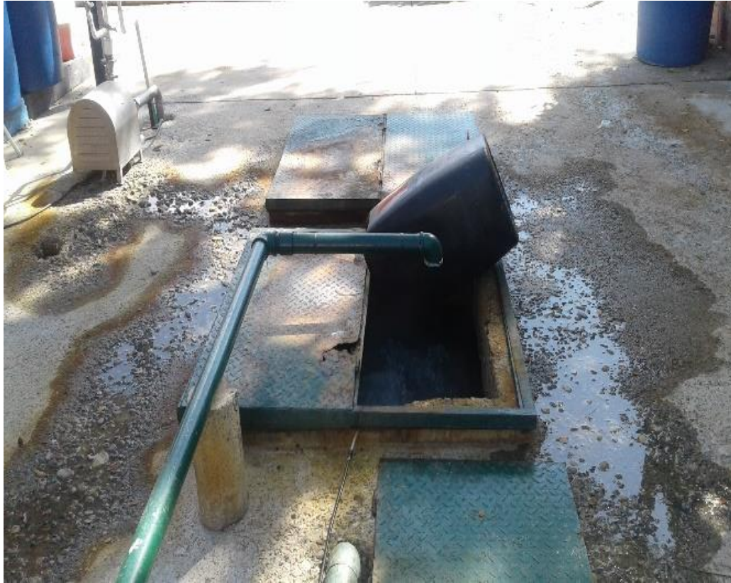
Figura 10. Tanque de preparación de ácido PTARI. Fuente: autor de la pasantía.
