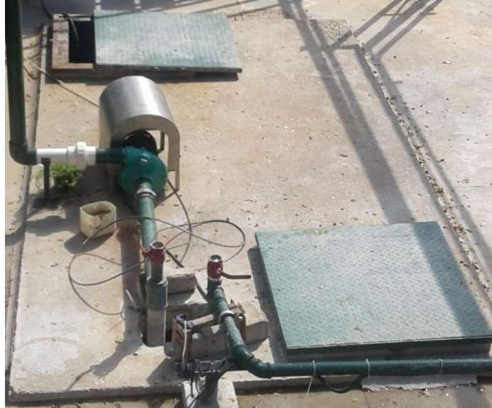
Figura 7. Tanque primario de la PTARI. Fuente: autor de la pasantía
