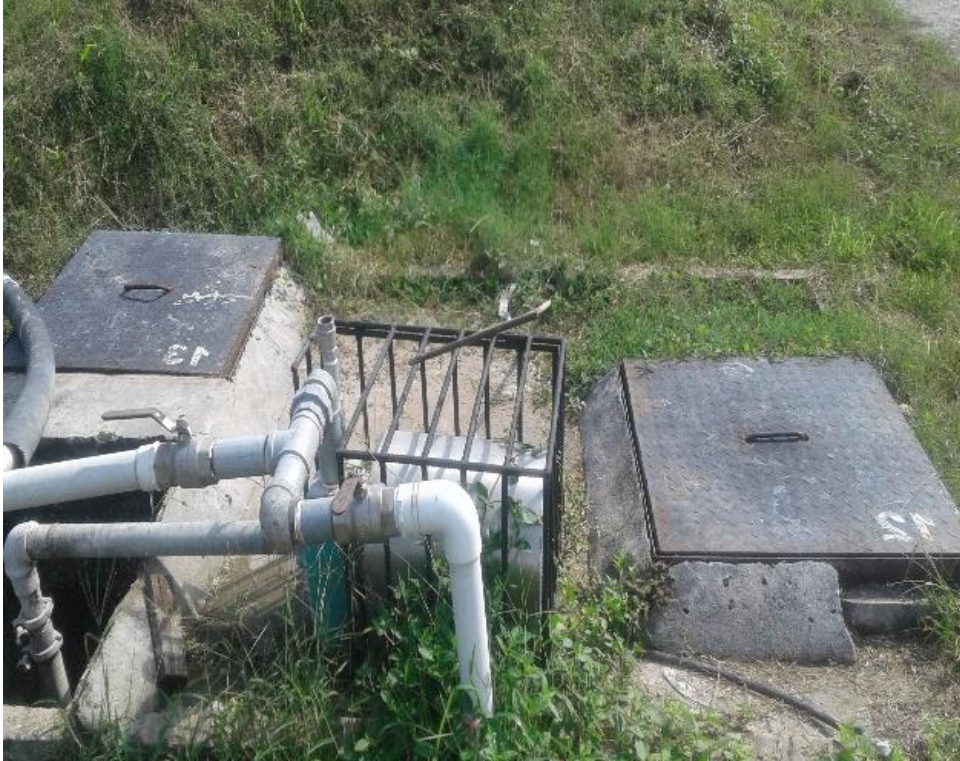
Figura 17. Tanque primario STARD. Fuente: autor de la pasantía
