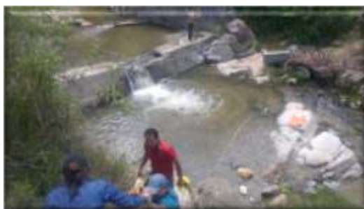
Figura 12 Estructura de la captación Quebrada El Tabaco
