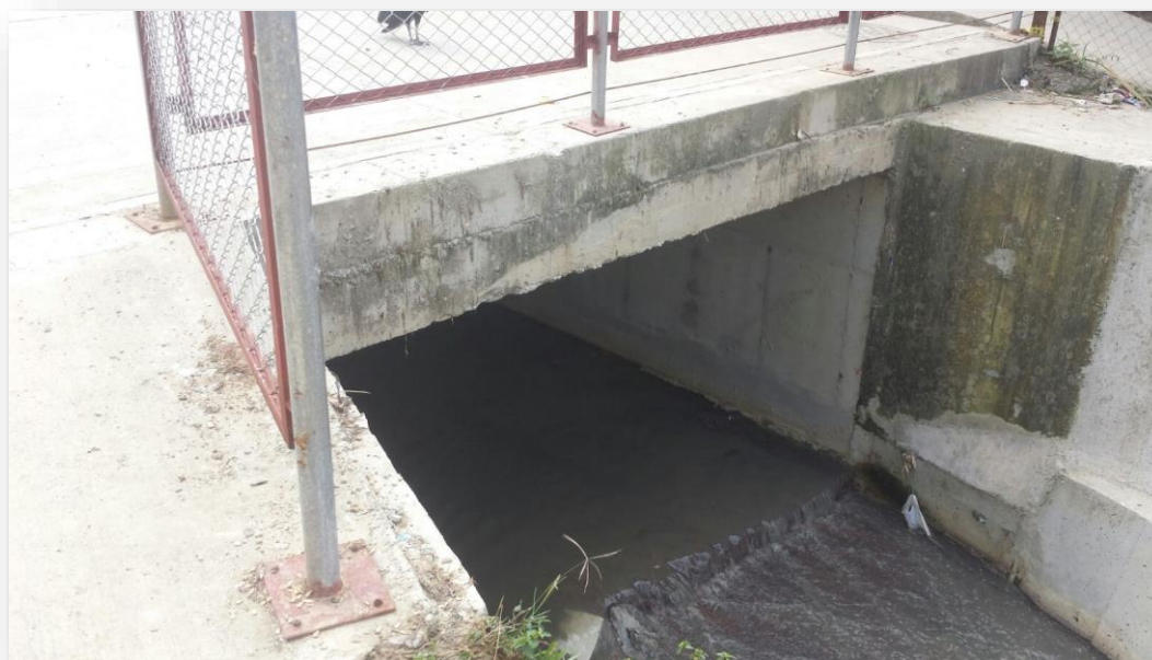
Fotografía 7. Cuenca rio chiquito, finalización de plan maestro de acueducto y alcantarillado San Antonio ubicación en el barrio Tacaloa
