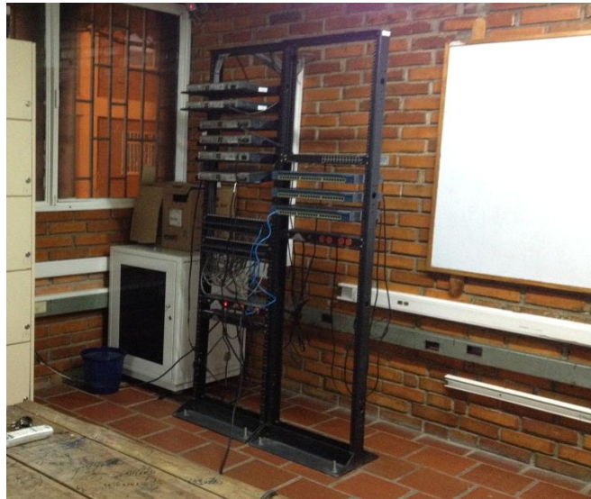
Figura 22. Rack Doble Activo
