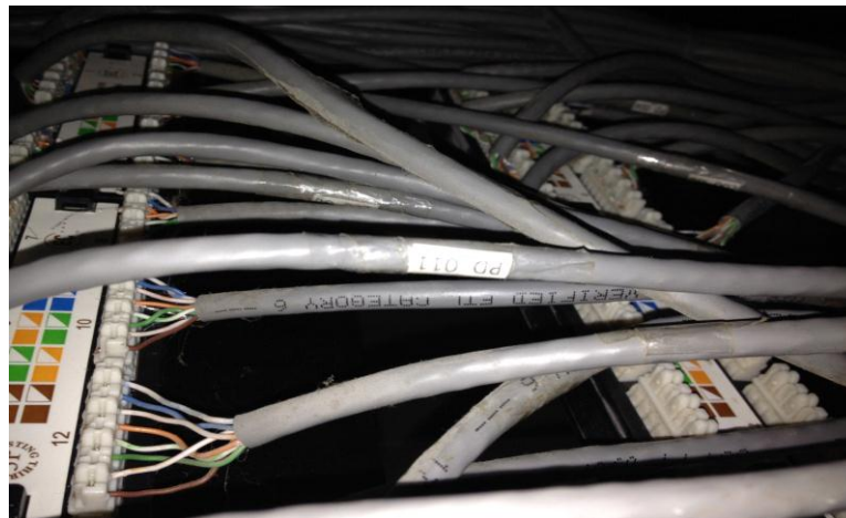
Figura 21. Patch cord en desorden, laboratorio Cisco.
