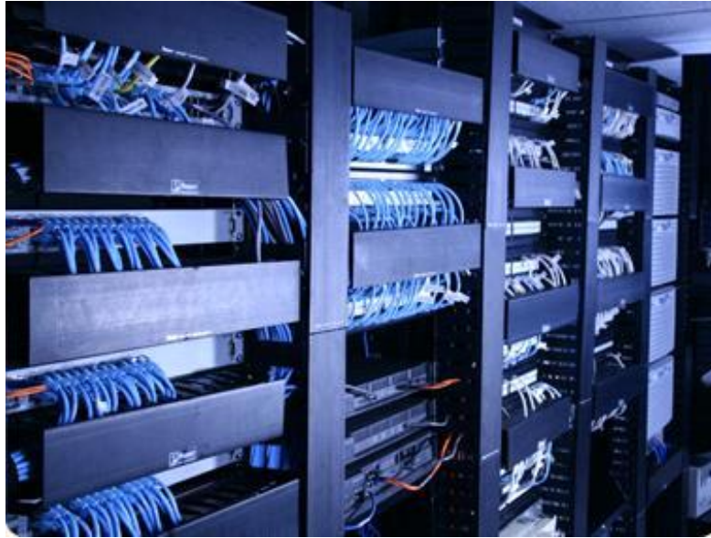
Figura 5. Cuarto de Equipos
