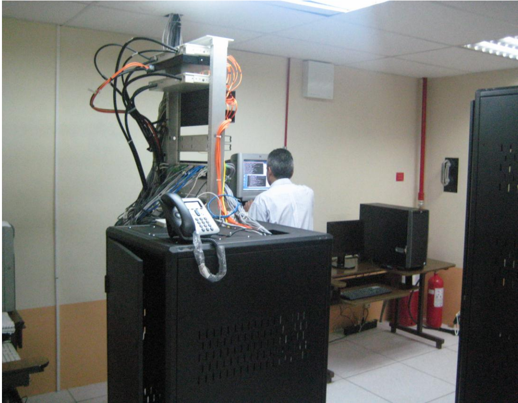
Figura 4. Cuarto de Telecomunicaciones
