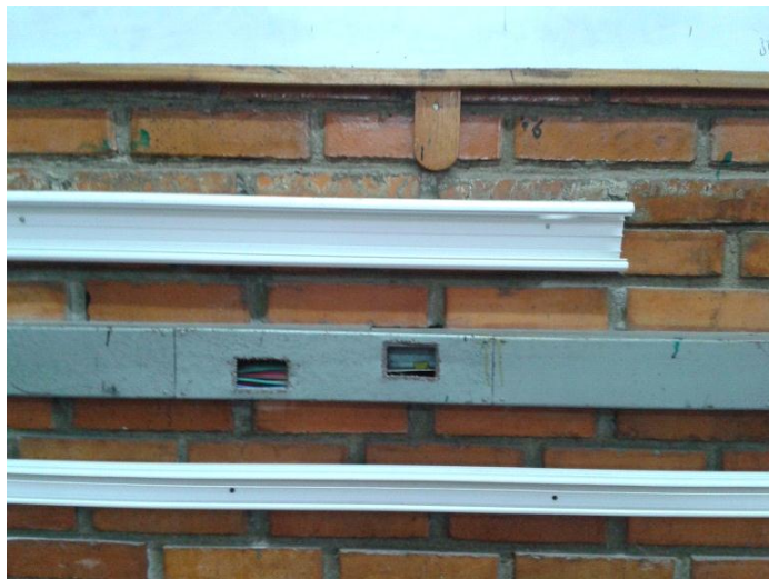
Figura 26. Canaleta Metálica sin UPS
