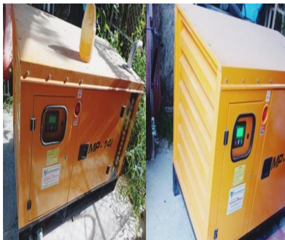
Figura 29. Mantenimiento de planta eléctrica.
