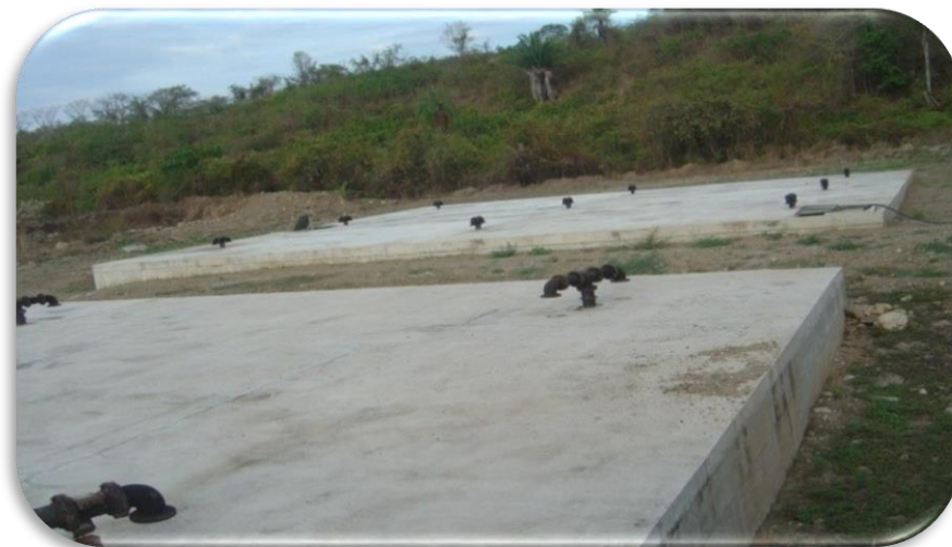
Figura 15. Tanques de almacenamiento. Fuente: Pasante del proyecto.
