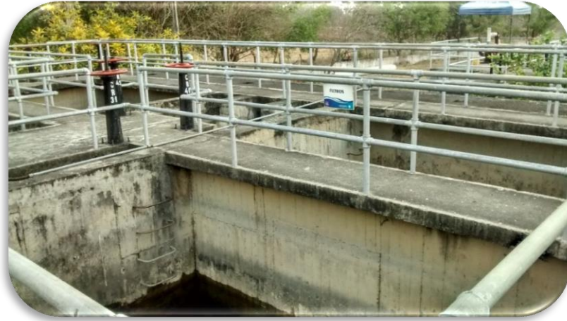
Figura 14. Filtros convencionales. Fuente: Pasante del proyecto.
