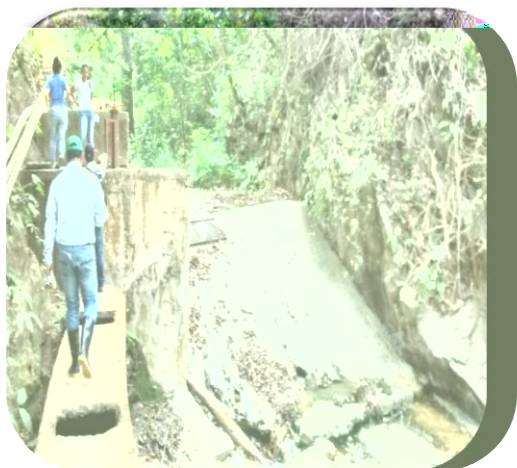
Figura 4. Punto de Captación
