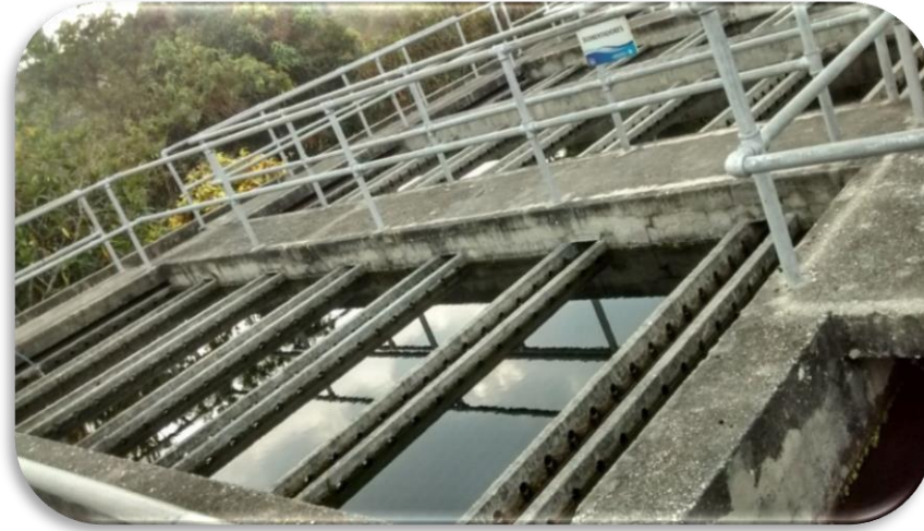
Figura 13. Sedimentadores de flujo vertical ascendente. Fuente: Pasante del proyecto.
