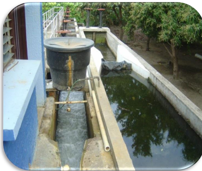
Figura 11. Canaleta Parshall de la PTAP. Fuente: Pasante del proyecto.
