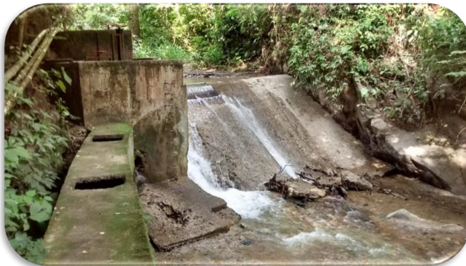
Figura 16. Estructura hidráulica llamada la bocatoma nueva con sección de rejilla de fondo. Fuente: Pasante del proyecto.
