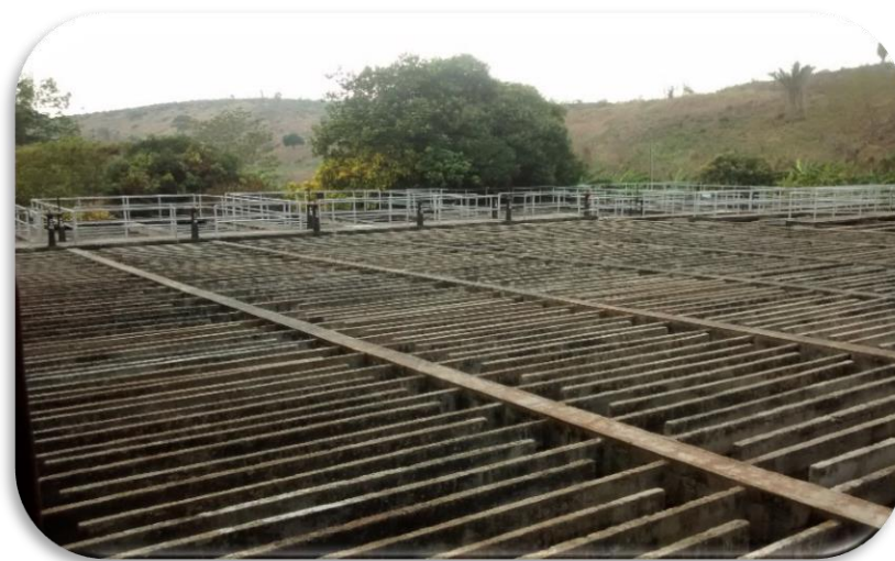
Figura 12. Floculadores de flujo horizontal. Fuente: Pasante del proyecto.
