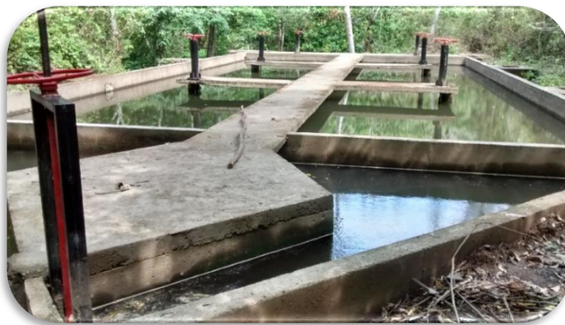
Figura 10. Estructura desarenadora. Fuente: Pasante del proyecto.
