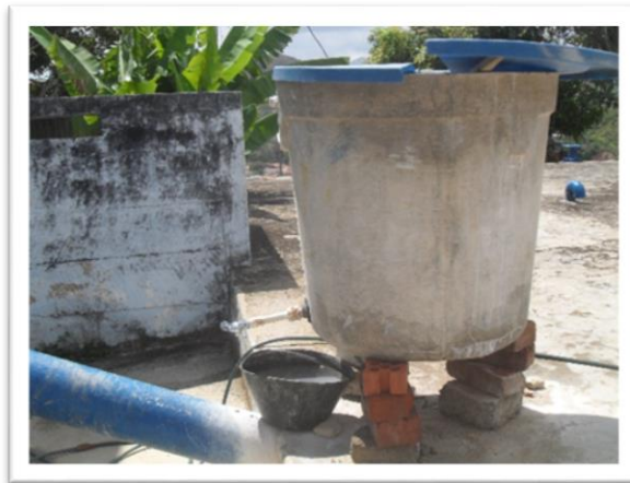
Imagen 15. Tanque de dosificación de cloro granulado al sistema de rebosadero del tanque N° 2 al N° 1.
