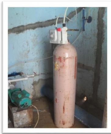
Imagen 14. Clorador E 10 K y cilindro de cloro gaseoso.
