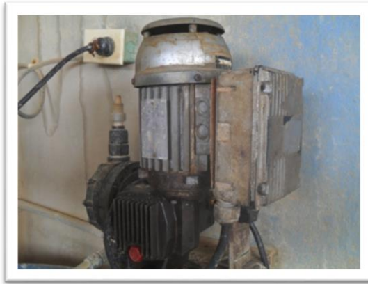
Imagen 12. Dosificador anterior sin funcionamiento.
