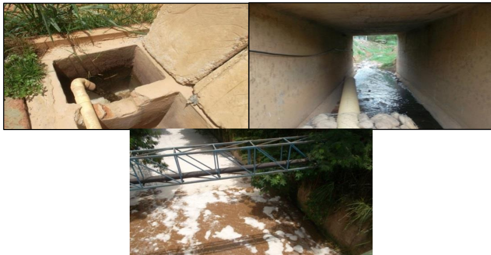
Fotografía 15. Salida del caudal con tratamiento.
