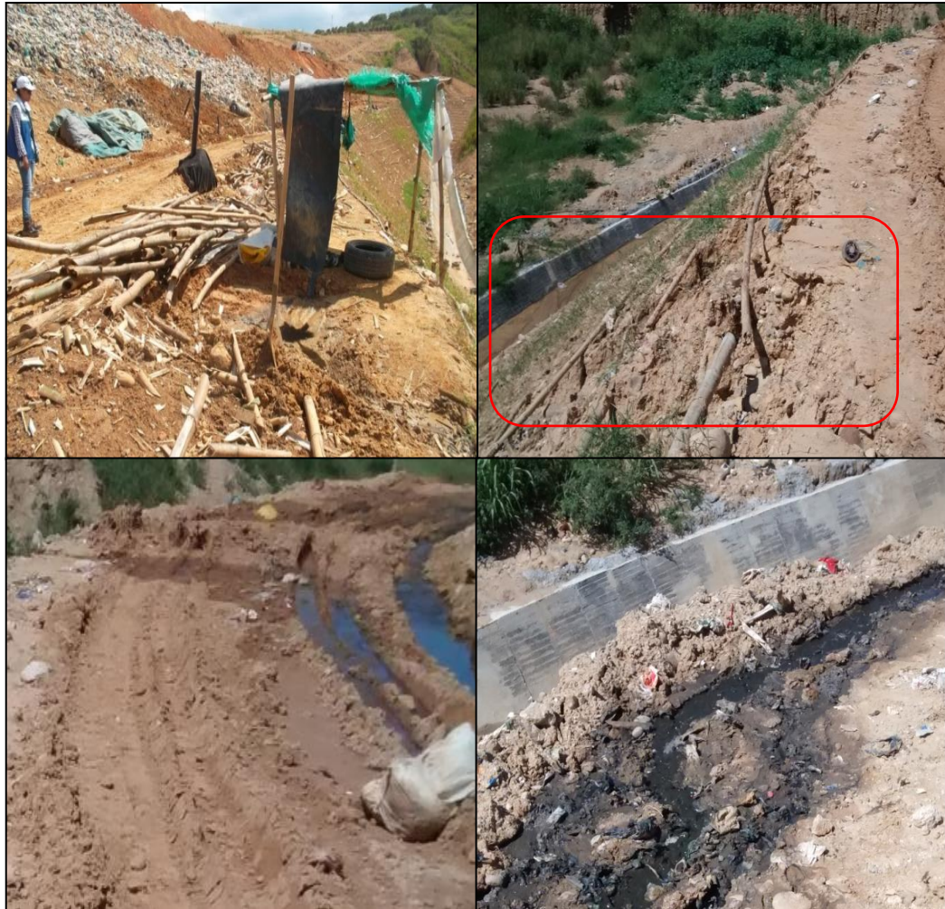
Fotografía 5. Socavación del costado del dique por acción de la escorrentía.
