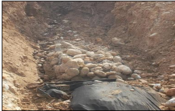
Fotografía 9. Filtro colector de lixiviado.
