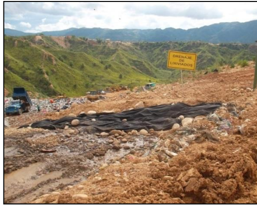
Fotografía 6. Zona de drenaje de lixiviados.
