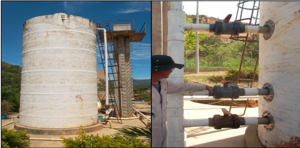
Fotografía 12. Reactor UASB y sistema de purga.
