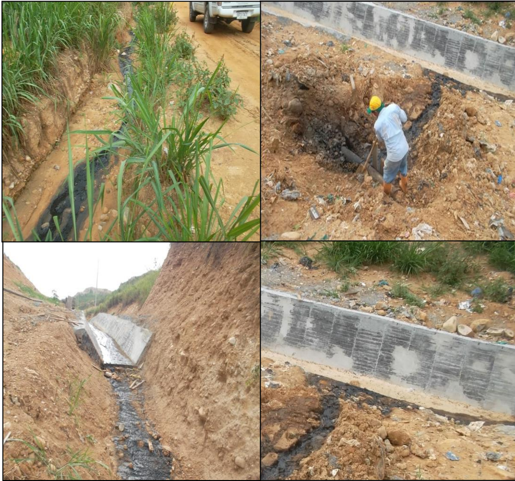
Fotografía 3. Punto de ruptura de tubería de conducción de lixiviados .
