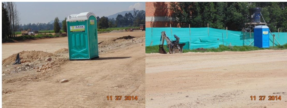
Foto 5. Instalaciones temporales (Baños portátiles).
