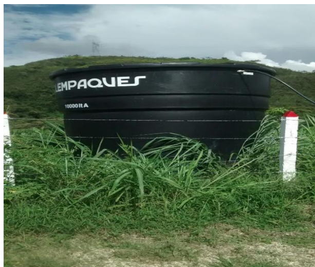
Foto 9. Tanque de 10.000 lt para el agua potable.
