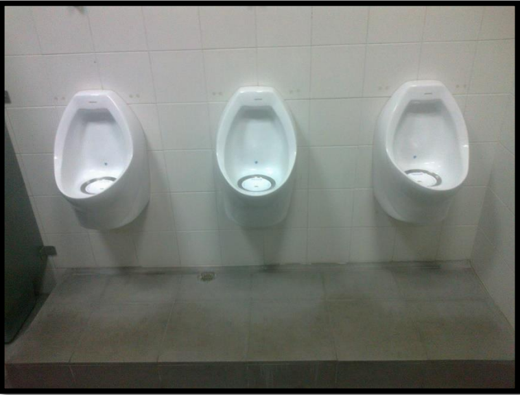
Fotografía 4. Orinales secos con sistema de membrana.
