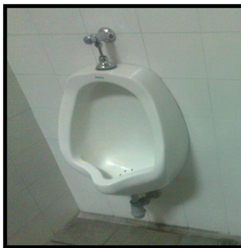
Fotografía 3. Orinal de cierre automático (con agua).
