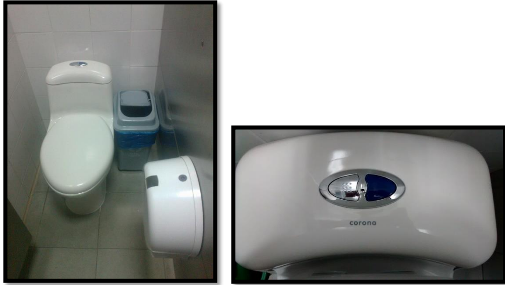
Fotografía 7, 8. Sanitarios Dual Flush
