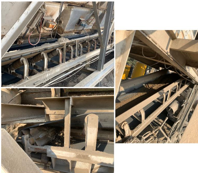
Banda Transportadora Concretos & Triturados El Zulia
