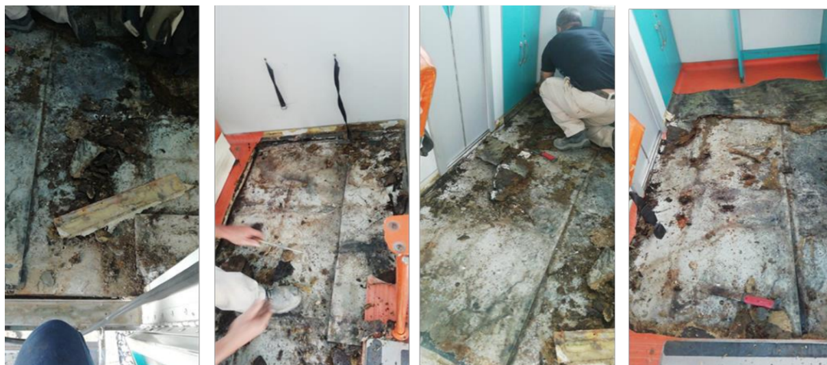
Figura 2. Estado de Piso consultorio 1, Unidad móvil
