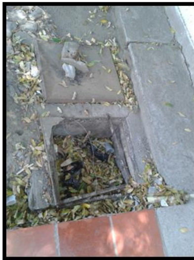
Foto 15: alcantarilla llena de hojarasca
