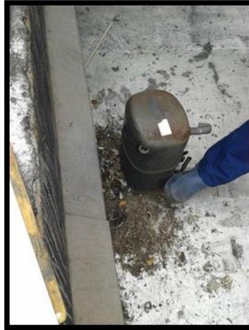
Foto 31: Residuos generados por palomas
