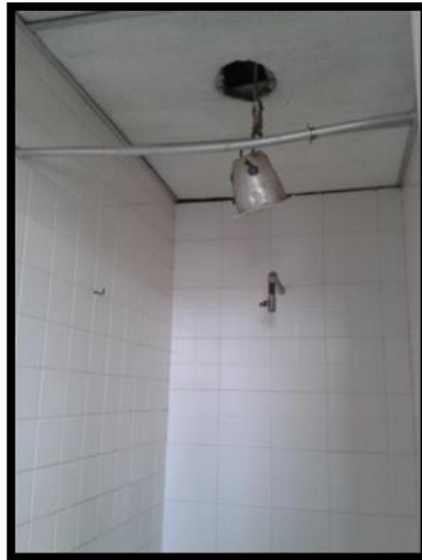
Foto 20: hueco en el techo del baño
